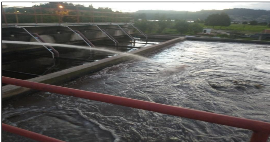
Figura 3. Proceso de Aireación de la Planta de Tratamiento de Agua Residual, Paipa.
