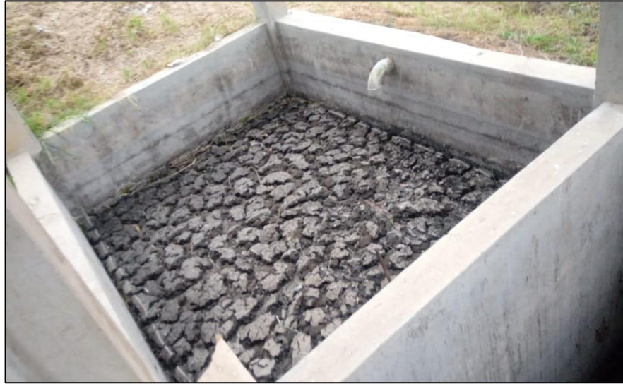
Figura 6. Lodo del lecho de secado del reactor UASB, tanque Imhoff y del digestor de lodos, Ptar Municipio de Sotaquirá
