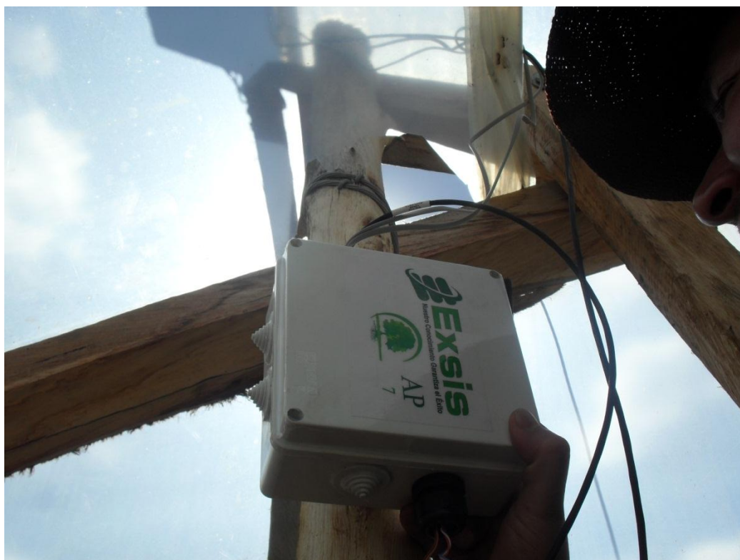
Figura 67. Caja estación meteorológica instalada
