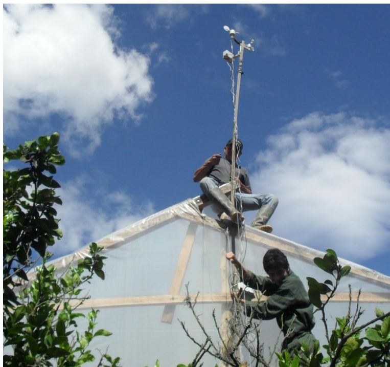
Figura 66. Instalación estación meteorológica
