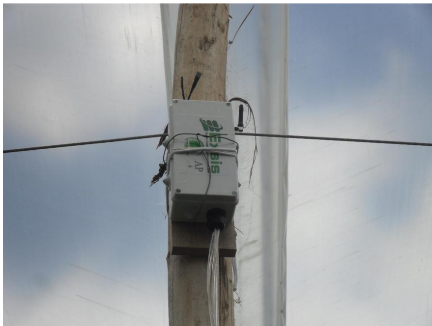
Figura 63. Caja con sensores de humedad ambiente y temperatura instalada
