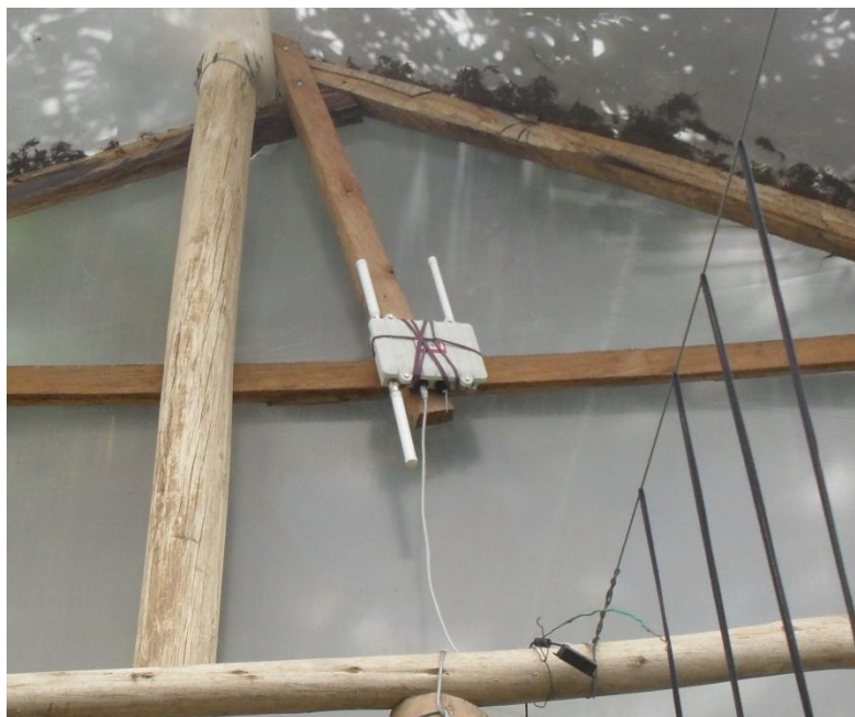
Figura 65. Concentrador Meshlium instalado
