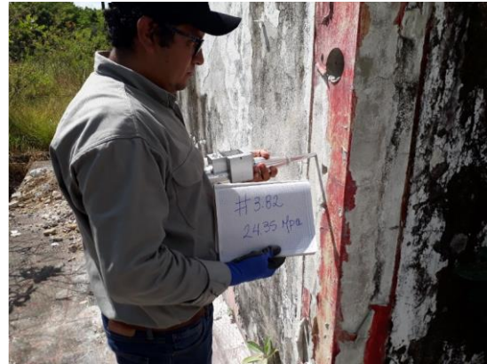
Figura 46. Prueba de esclerómetro Punto No 382.
