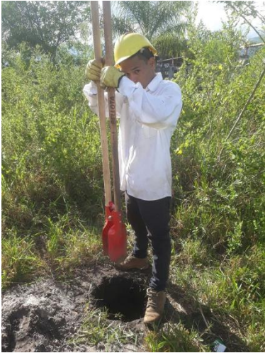
Figura 31. Abertura superficial de exploración. Fuente: Fotografías del autor.
