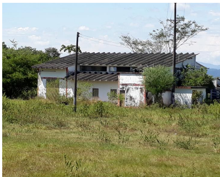
Figura 55. Estado de la edificación en el mes de diciembre de 2017 -fachada oriental. Fuente: Fotografías del autor.
