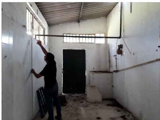
Figura 16. Cuarto Auxiliar. Fuente: Fotografías del autor.
