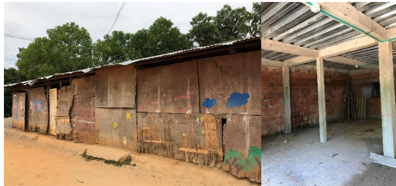
Figura 90. Escuela. Estado de sus construcciones.
