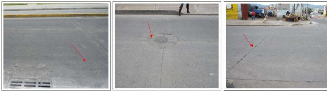
Fotografía 9. Grieta en esquina, grieta en pozos, desportillamiento de juntas Fuente: de este estudio – 2016
