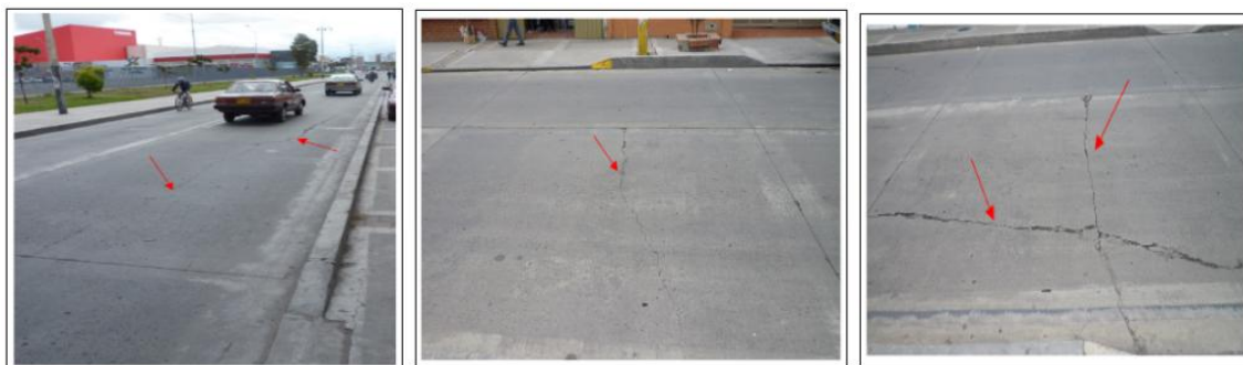
Fotografía 8. Grieta longitudinal, grieta transversal y grieta en bloque
