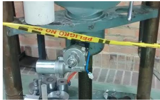
Figura 28 moto reductor instalado Tomado de: AUTOR
