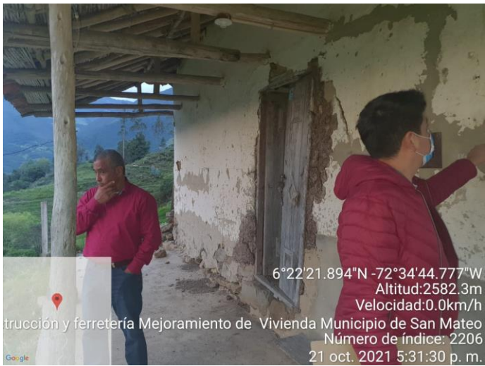
Fotografía 11. Vivienda objeto de mejoramiento Elaboración. Contraloría General de Boyacá
