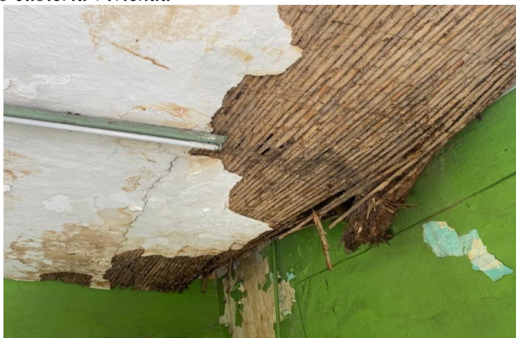
Figura 29. Colapso cubierta Vivienda
