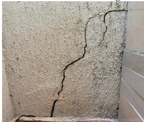
Figura 25. Seguimiento agrietamiento Urbanización Santiago de Compostela
