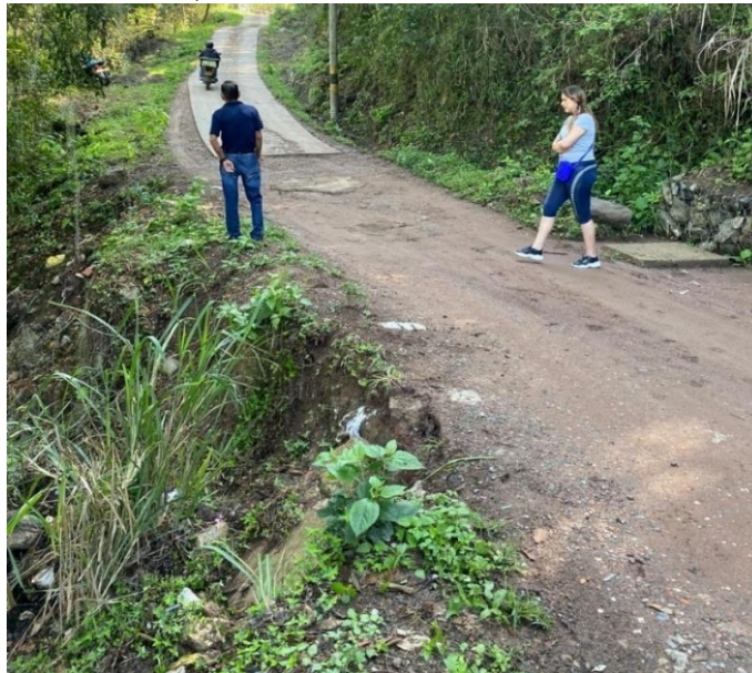
Figura 27. Desprendimiento de vía, vereda Canchón
