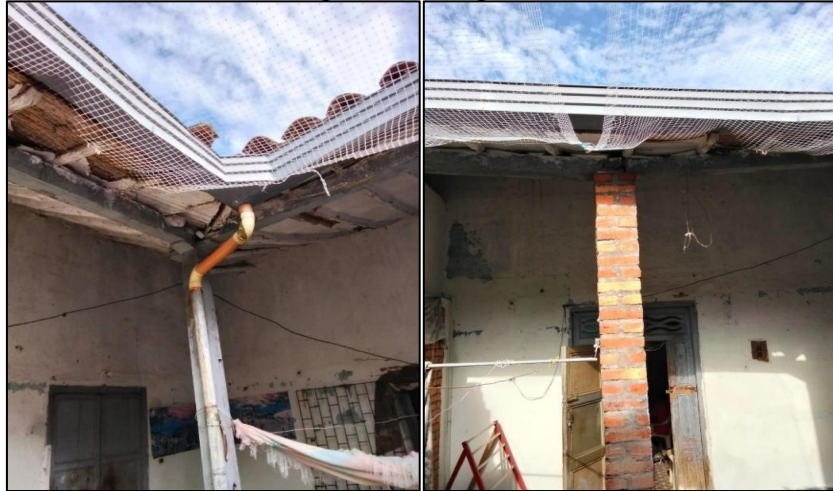
Figura 39. Visita técnica a vivienda con posible colapso de cubierta
