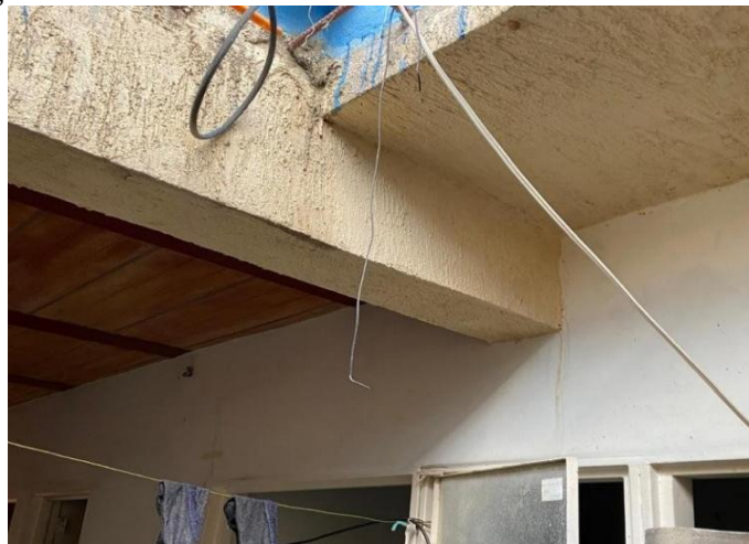
Figura 28. Sobrecarga estructural vivienda en barrio Bella Vista
