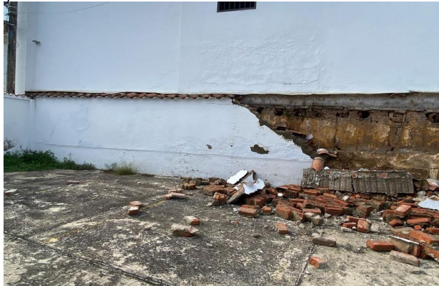
Figura 37. Desprendimiento muro Hotel Tamacara
