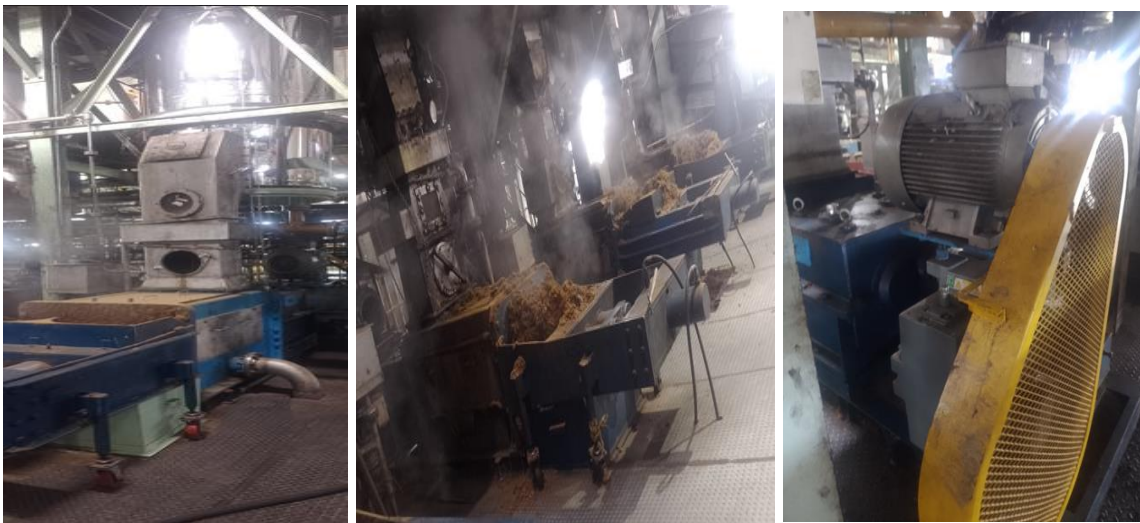
Prensas y sistema digestor prensa de la planta de Manuelita
