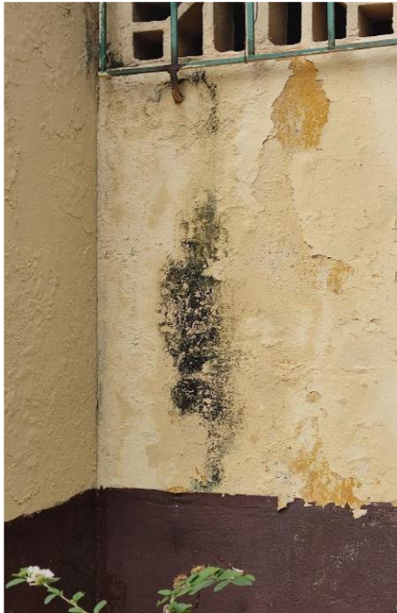
Figura 4. Presencia de humedad y descascaramiento de pintura.
