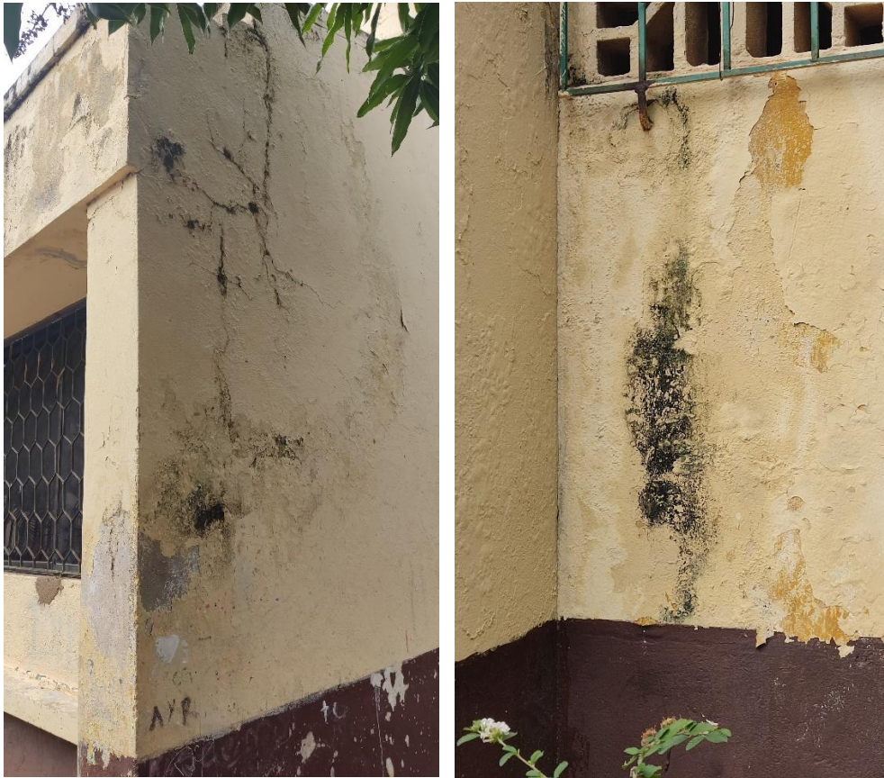
Figura 9. Humedades en muros.
