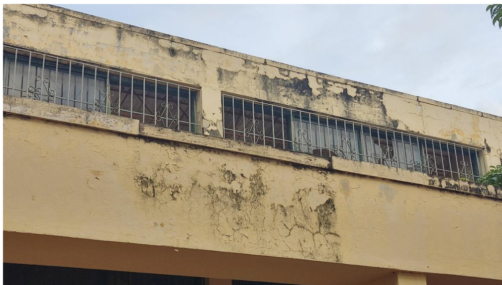
Figura 10. Humedades en Antepechos.
