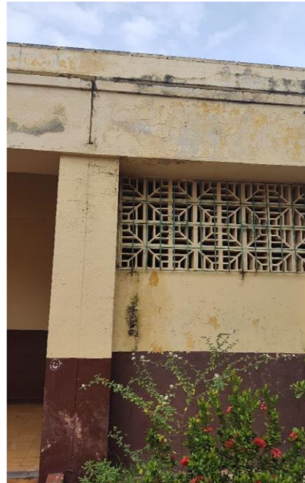
Figura 5. Presencia de humedad en antepecho y columnas.
