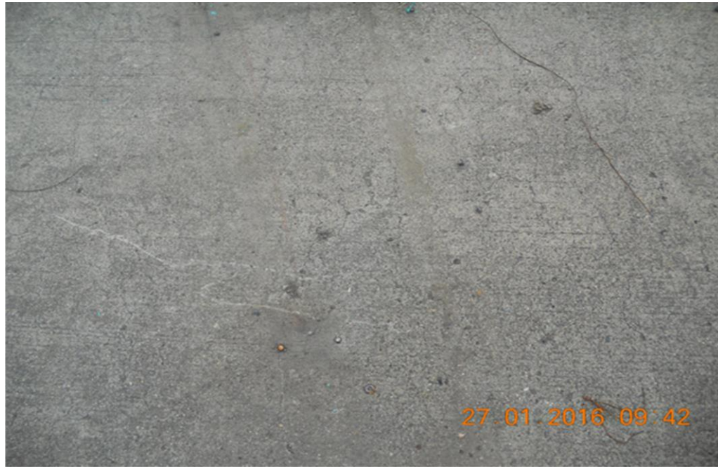
Figura. 35 Fisuración en placa de plataforma
