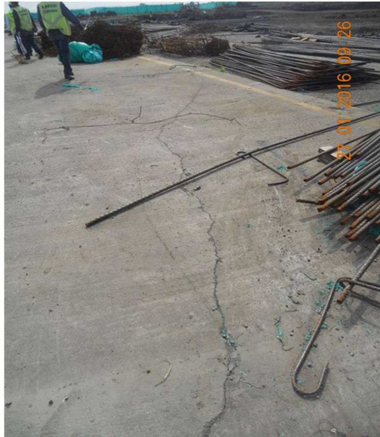
Figura. 23 Grietas longitudinales en plataforma
