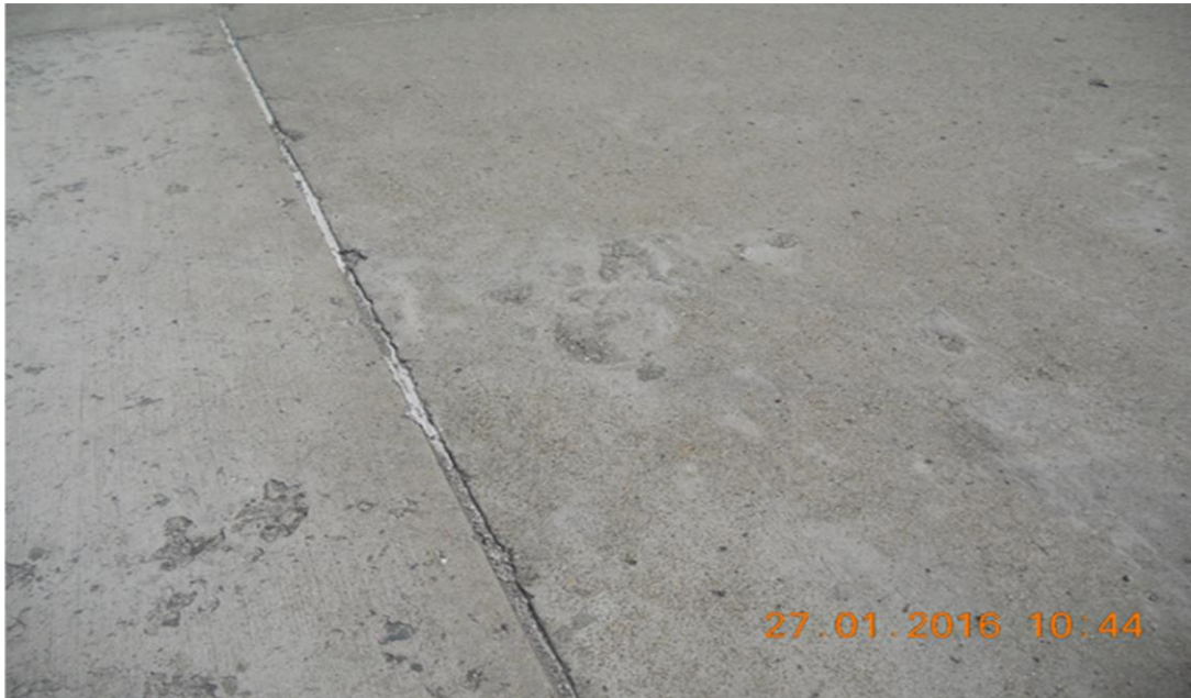
Figura. 17 Deficiencia del sellado de las juntas de la plataforma
