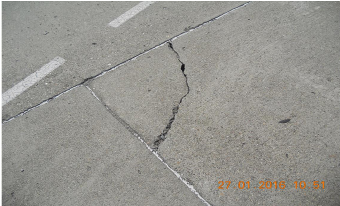
Figura. 21 Grietas de esquina
