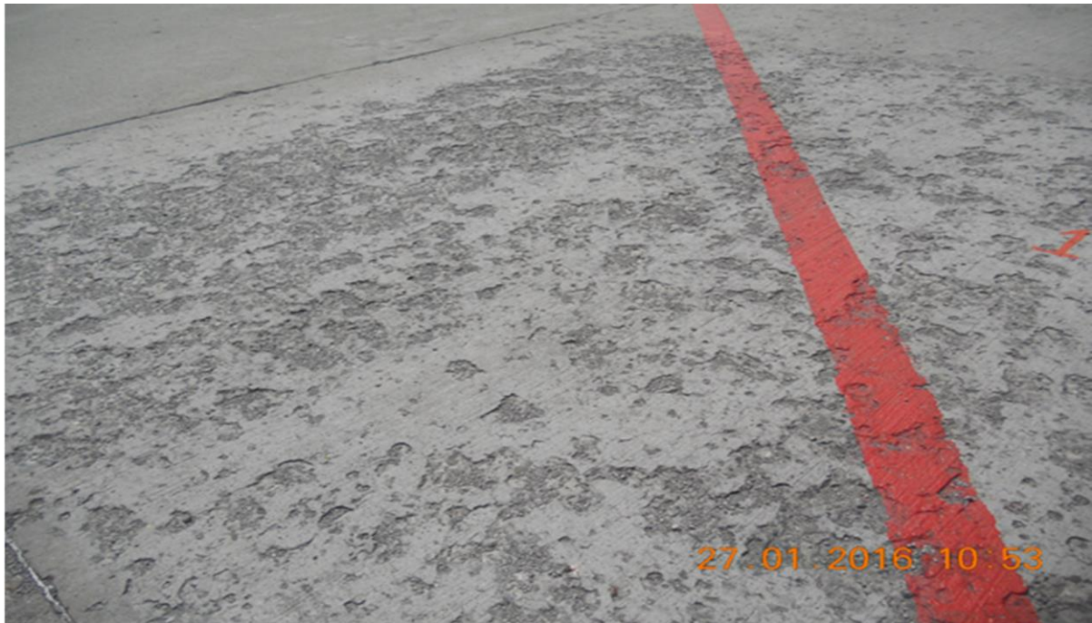
Figura. 27 Placas que presentan descascaramientos
