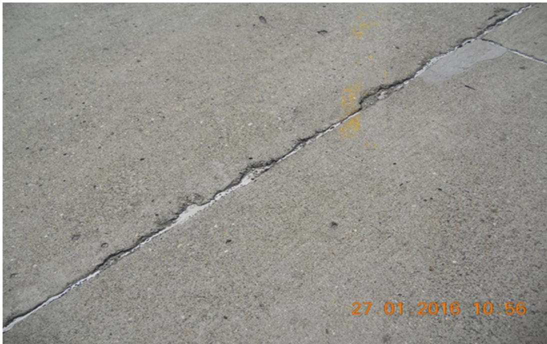
Figura. 19 Desportillamiento de las juntas
