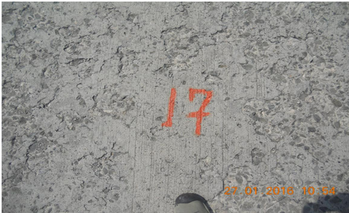
Figura. 29 Desintegración de la matriz de concreto en placa 17
