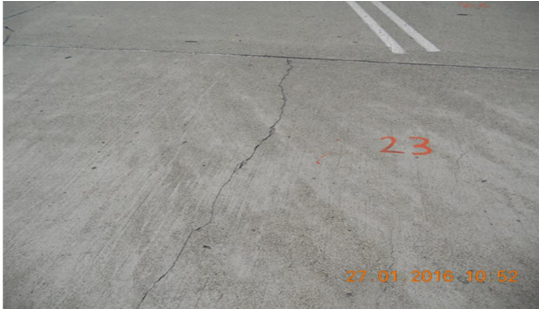
Figura. 25 Placas que presentan grietas Transversales
