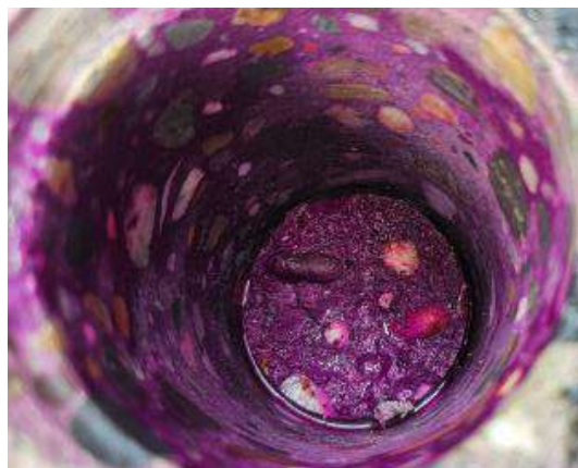
Ilustración 63. Carbonatación Orificio Núcleo No2.
