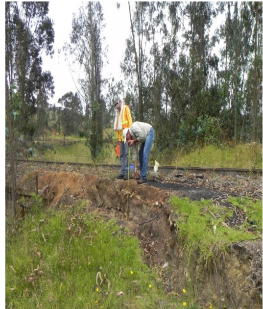
Figura 42 Vista del escarpe, nótese lo cerca que está la corona del escarpe a la red férrea. Fecha 12 – abril – 2014 Fuente: Propia
