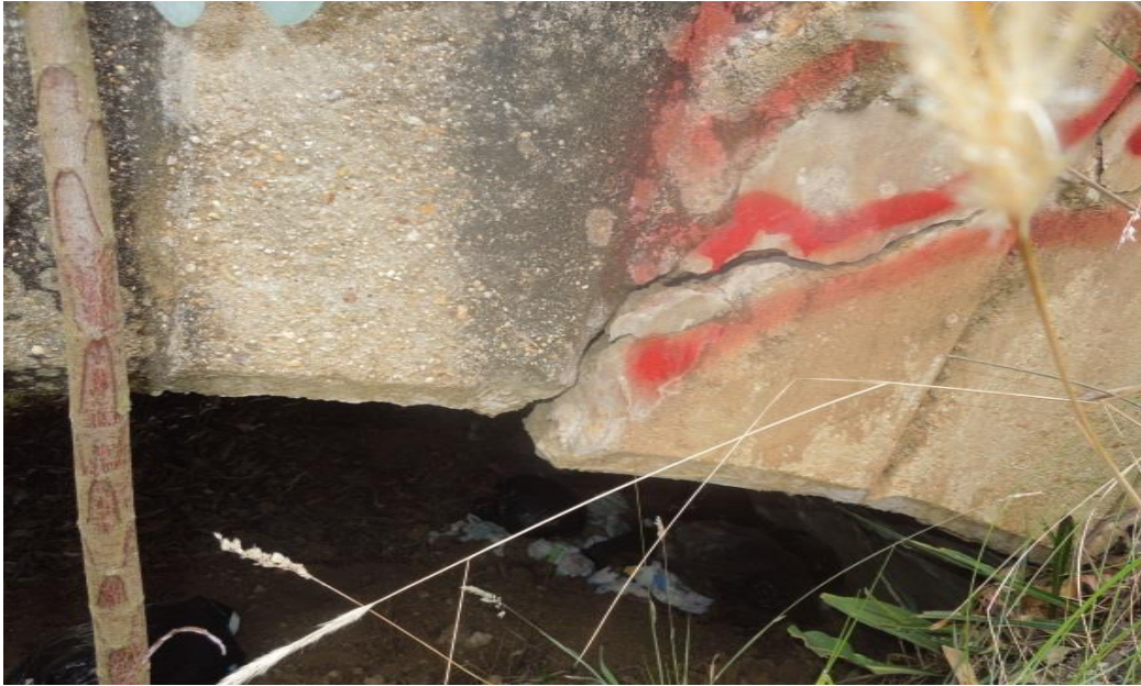
Figura 28 Detalle fisura A1F1. Nótese que el concreto de la margen derecha ha sido reparado. Se observa el descolgamiento de la cuña de concreto, que hace pensar que los arcos de concreto no son reforzados, sin embargo esta apreciación será confirmada con los ensayos de campo Fuente: Propia
