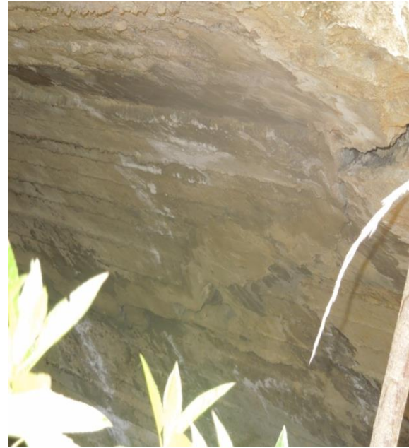
Figura 31 Arco A1. Lesiones de infiltración de agua, humedad y problemas de carbonatación del concreto. Fuente: Propia
