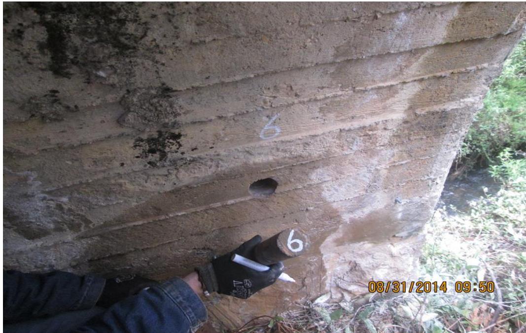
Figura 9 Recuperación del núcleo en la base del arco. Fuente: Propia
