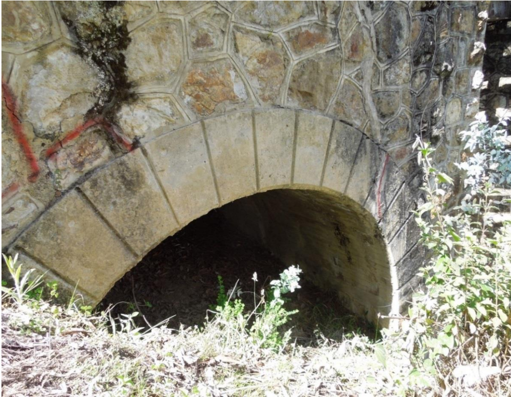
Figura 35 Arco #2. Detalle fisuras A2F1 y A2F2 Fuente: Propia
