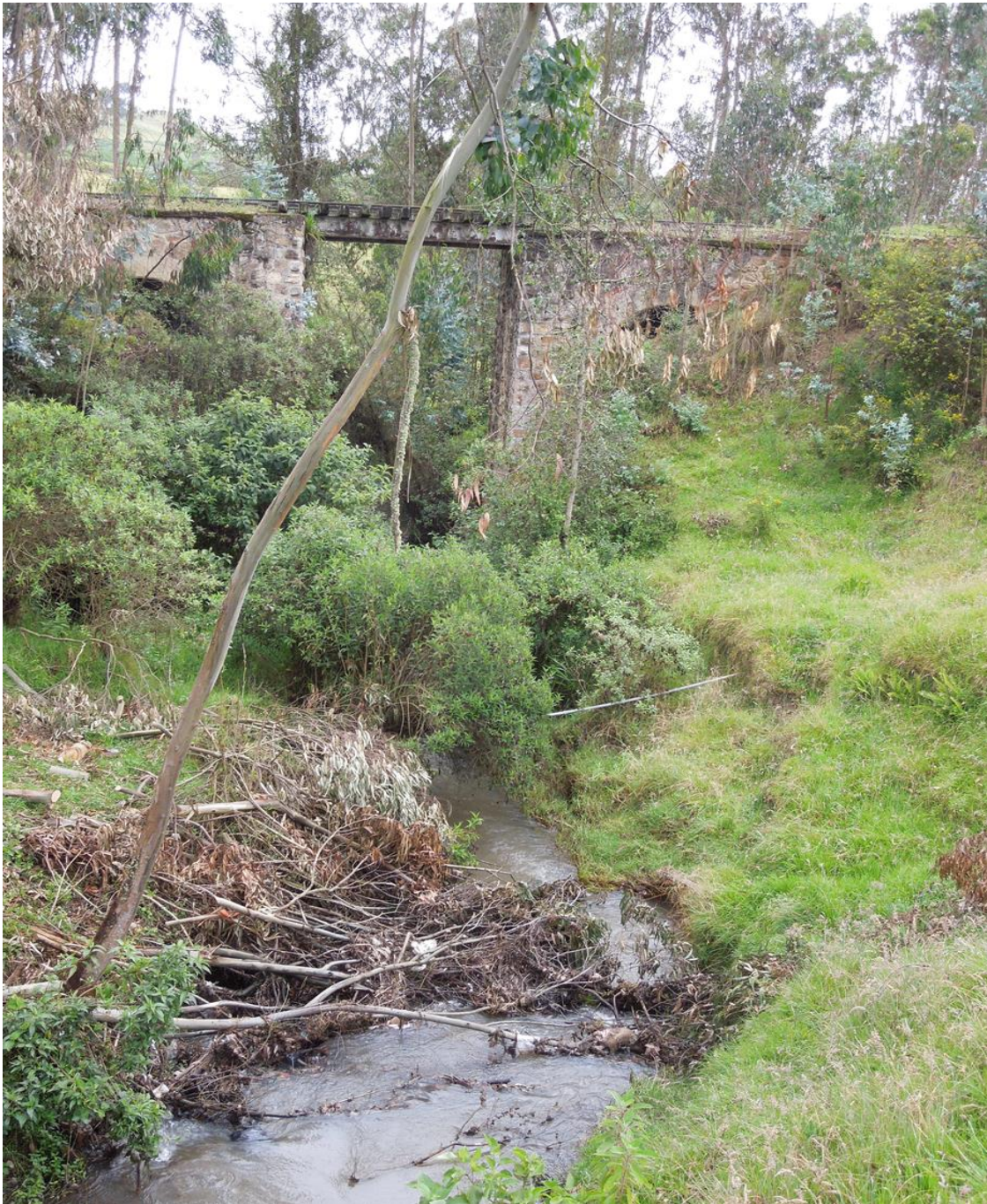
Figura 56 Detalle del talud aguas arriba del puente. Obsérvese otros escarpes menores en el talud, por acción de la quebrada, que muy seguramente en épocas de creciente ha arrastrado material de lado y lado de la quebrada, perdiendo soporte la pata del talud, provocando el deslizamiento del material.
