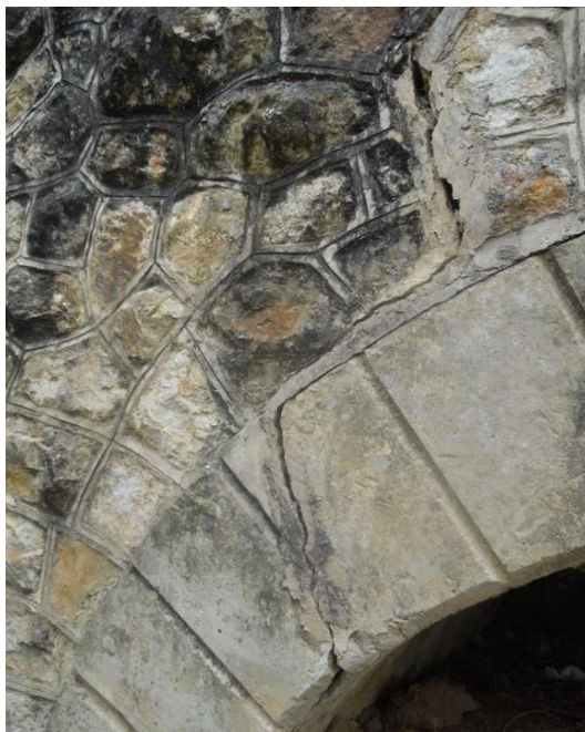
Figura 22 Arco #1. Detalles fisura A1F2. Fuente: Propia
