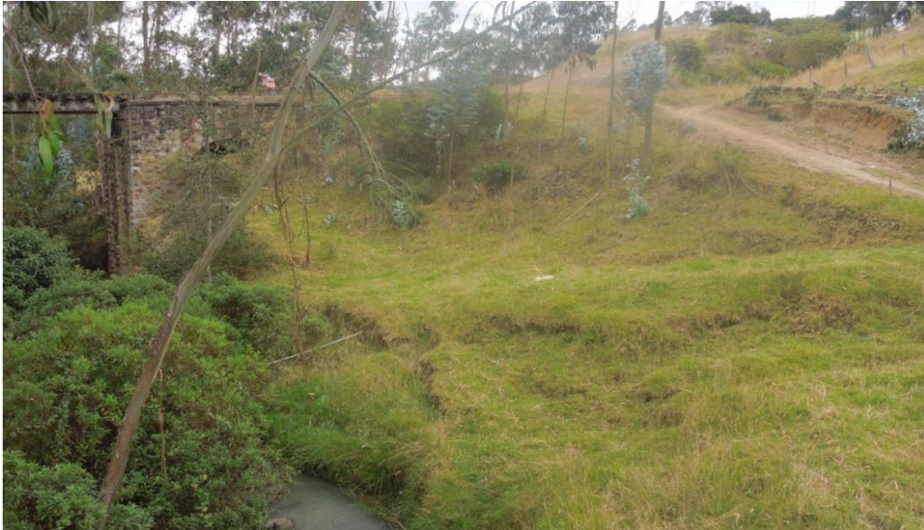
Figura 45 Nótese los desplazamientos del talud, por pérdida de material en la pata del talud, por acción de las aguas, observándose las coronas de dichos escarpes. Fecha 12 abril 2014 Fuente: Propia
