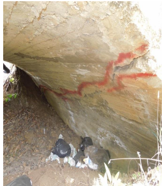
Figura 27 Arco #1. Detalles fisura A1F1. Nótese que la fisura atraviesa la totalidad del arco Fuente: Propia
