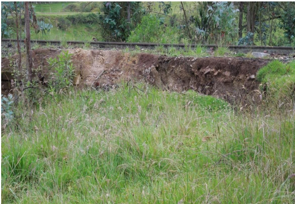
Figura 44 Detalle escarpe MD aguas arriba. Fecha 13 – junio de 2014 Fuente: Propia
