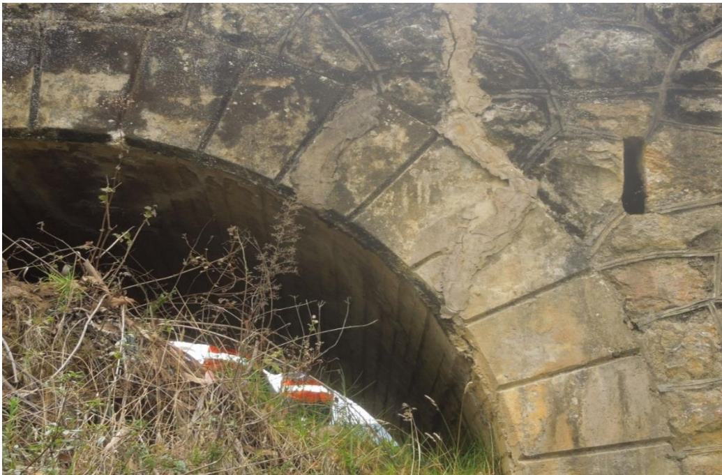
Figura 33 Vista aguas abajo. Detalle de la lesión A1F2. Vista aguas abajo. Nótese que la fisura fue resanada anteriormente, sin embargo no atraviesa el arco. Fuente: Propia
