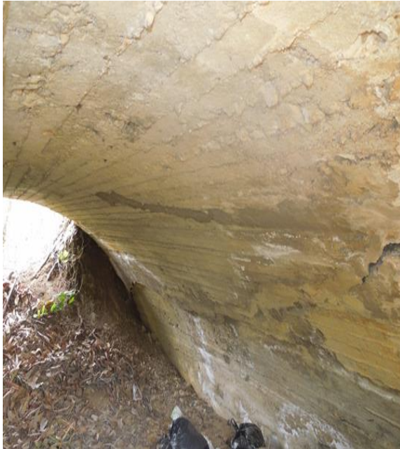
Figura 30 Arco A1. Lesiones de infiltración de agua, humedad y problemas de carbonatación del concreto Fuente: Propia
