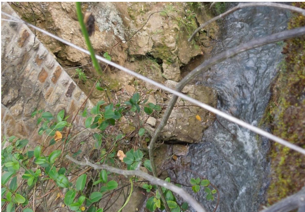
Figura 53 Talud MD aguas arriba. Detalle del bloque de material sobre el lecho de la Qda. Y la cuña próxima a desprenderse. De fecha 9-agosto 2014 Fuente: Propia
