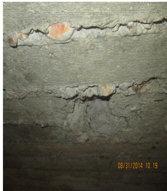
Figura 13 Concreto del arco con sobre tamaños del agregado Fuente: Propia
