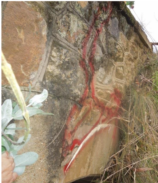
Figura 26 Detalles fisura A1F1 Fuente: Propia
