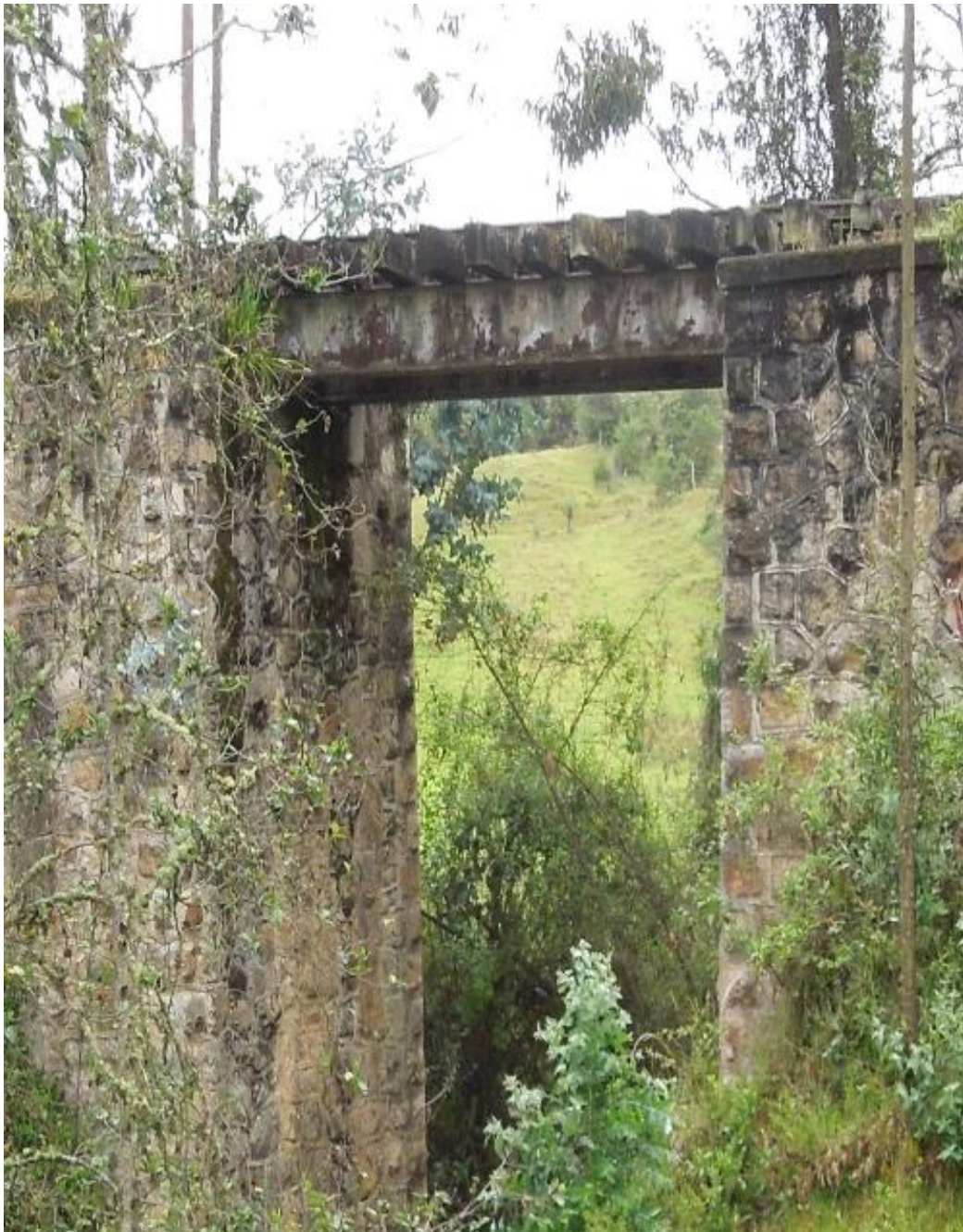
Figura 38 Vista longitudinal luz central, aguas arriba. Vigas metálicas de alma llena. Fuente: Propia
