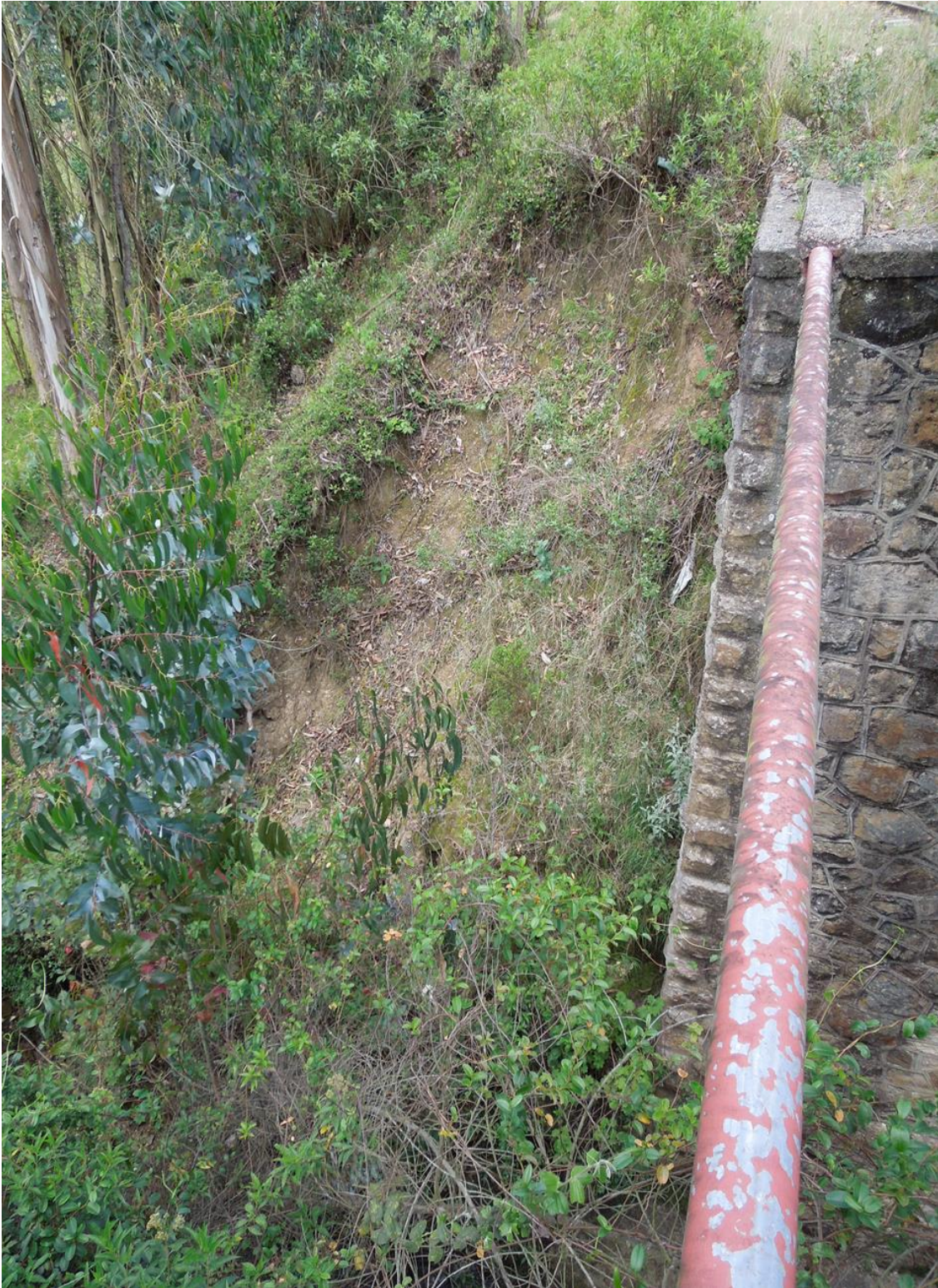
Figura 55 Talud MD aguas abajo. Nótese la erosión dada la alta pendiente Fuente: Propia
