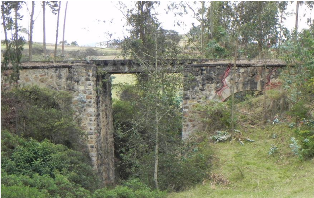
Figura 21 Vista longitudinal del puente. Arco No. 1. Fisuras en el arco y tímpano, A1F1 y A1F2 Fuente: Propia
