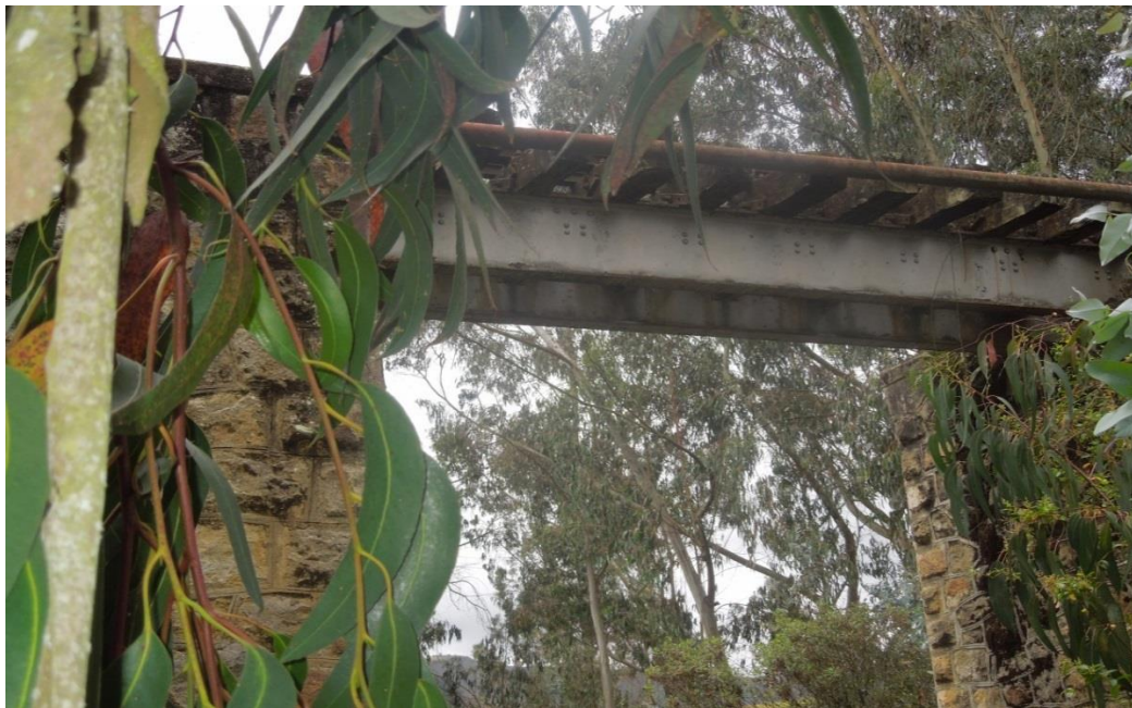
Figura 40 Vista longitudinal luz central, aguas arriba. Vigas metálicas de alma llena. Aguas abajo, nótese que el estado de las vigas es mejor que aguas arriba, muy probablemente, por la acción del viento. Fuente: Propia
