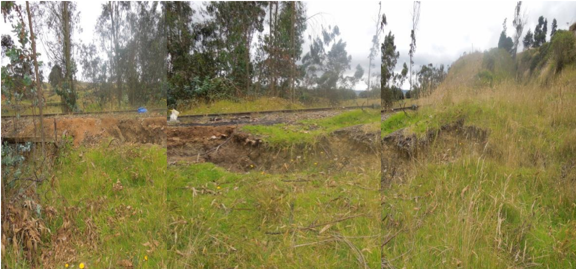
Figura 43 Detalle del escarpe MD, aguas arriba, nótese la proximidad de la corona del escarpe con la vía férrea Fuente: Propia
