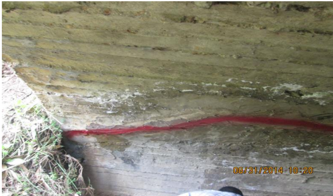
Figura 15 Demarcación de fisuras Fuente: Propia
