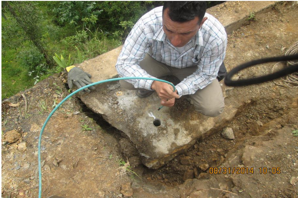
Figura 11 Inyección de agua, al taladro, en el proceso de la extracción del núcleo Fuente: Propia
