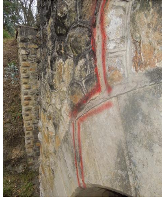
Figura 25 Arco #1. Detalles fisura A1F2 Fuente: Propia
