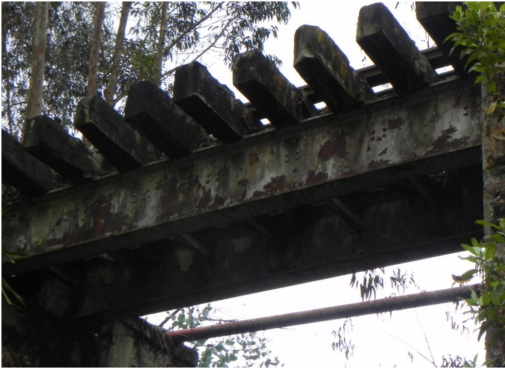
Figura 39 Detalle de daños en la estructura metálica de corrosión. Grado de corrosión alto. Vista aguas arriba Fuente: Propia
