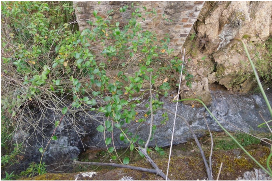
Figura 52 Talud MD aguas arriba. Obsérvese la cuña de terreno que está próximo a desprenderse. De fecha 9-agosto 2014 Fuente: Propia
