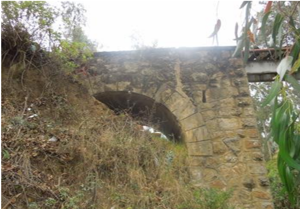
Figura 32 Arco #1. Vista aguas abajo. Presenta dos (2) fisuras verticales (A1F1, A1F2) en el plano x- z. Las fisuras, atraviesan el arco como se observa en las fotografías siguientes Fuente: Propia
