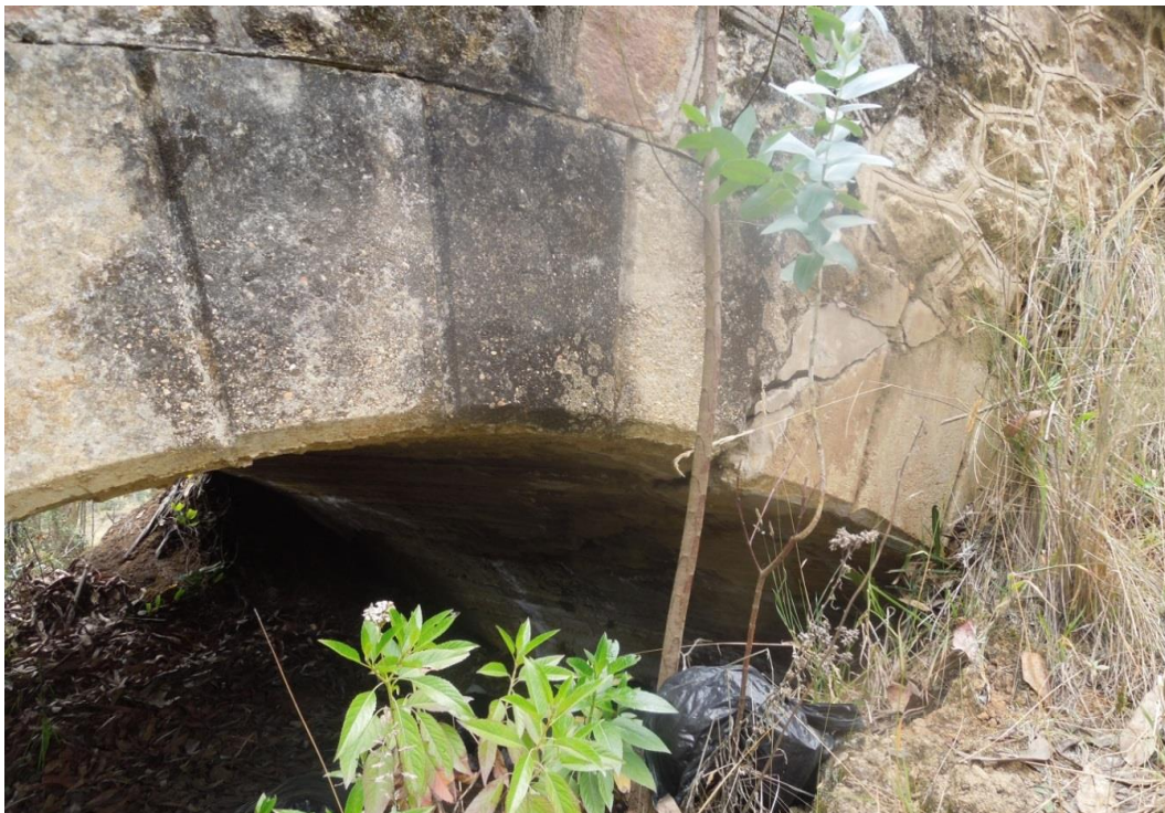
Figura 29 Arco A1 – lesión A1F1. Nótese las diferencias en las texturas de los concreto, que nos permite deducir que el concreto de la margen la izquierda, corresponde a la estructura original, mientras que el de la derecha, es un concreto más joven. Fuente: Propia
