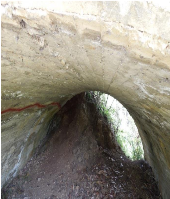
Figura 36 Arco #2. Detalles de las fisuras. Lesión A2F1 Fuente: Propia
