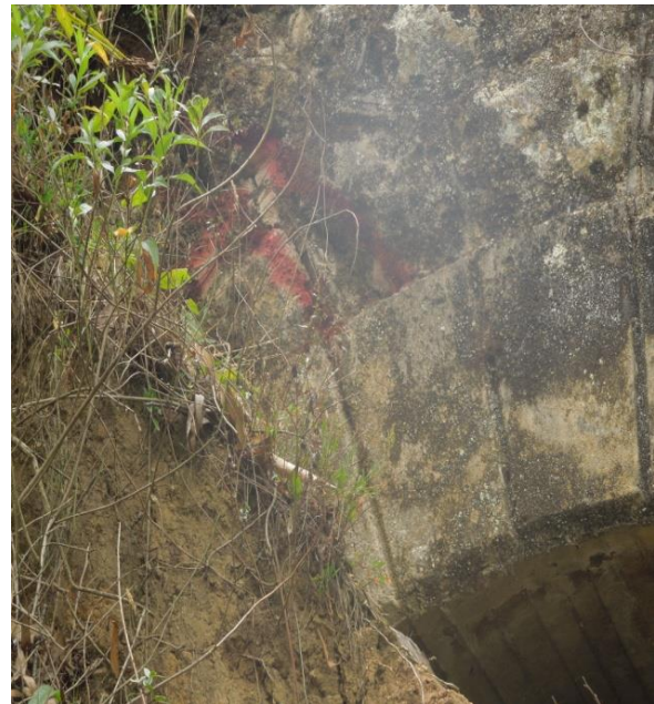
Figura 37 Arco #2. Detalles de las fisuras. Lesión A2F1 Fuente: Propia
