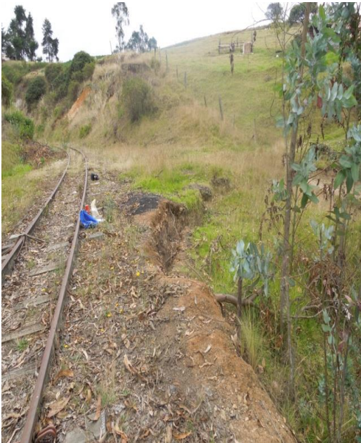
Figura 41 Vista del escarpe, nótese lo cerca que está la corona del escarpe a la red férrea. Fecha 12 – abril – 2014 Fuente: Propia
