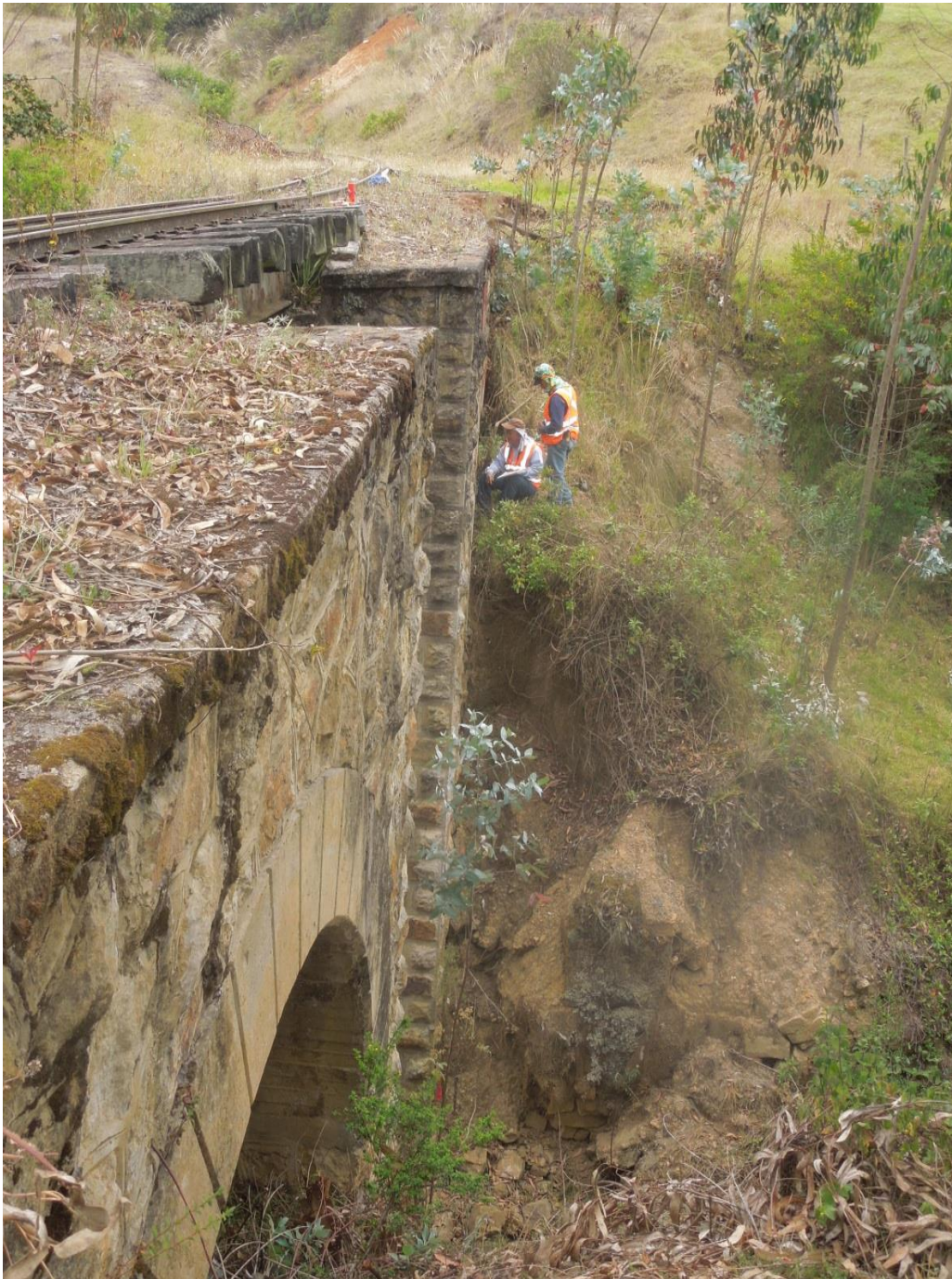
Figura 51 Talud margen derecha aguas arriba. Nótese la erosión del talud. Fecha 12 – abril – 2014 Fuente: Propia
