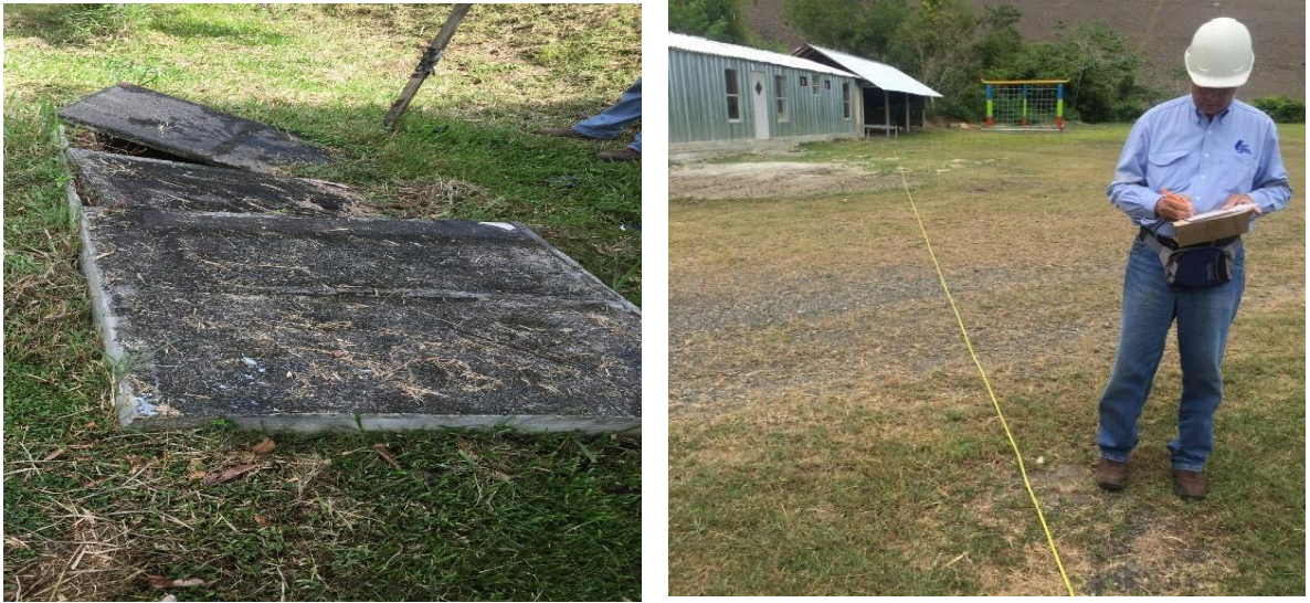
Imagen 34. Tanque Séptico Anterior y registro de distancia
