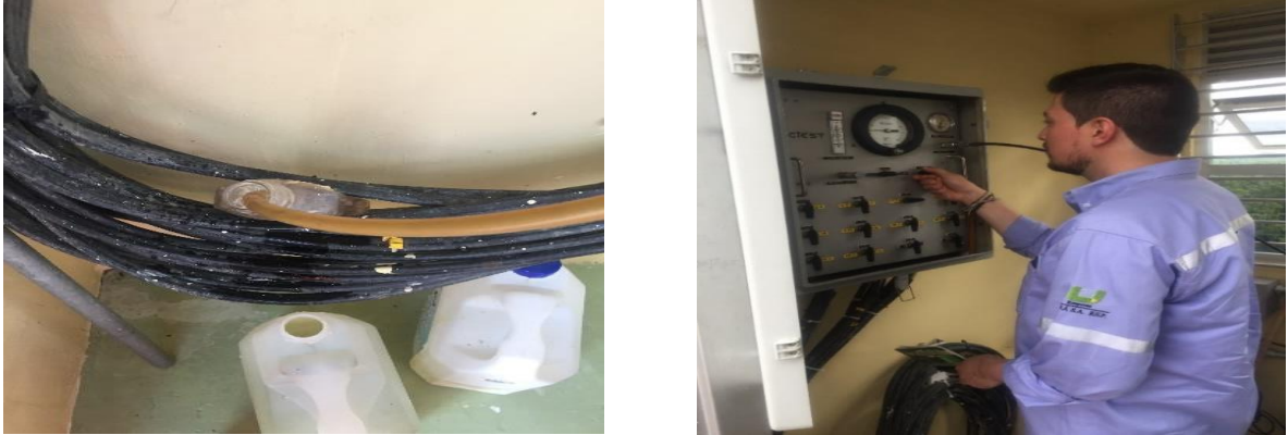
Imagen 9. Piezómetro Neumático. Consola principal, avería y toma de datos
