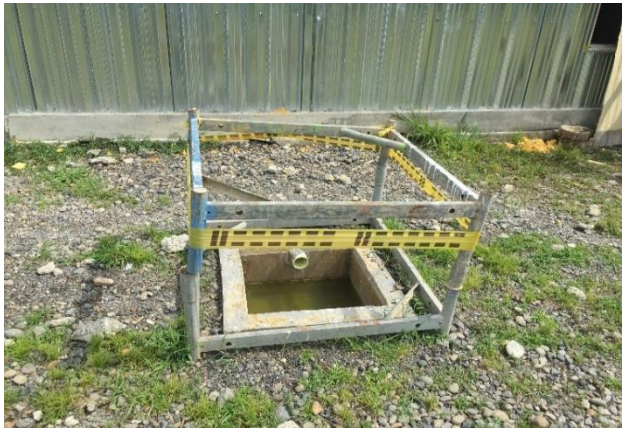
Imagen 31. Caja de inspección
