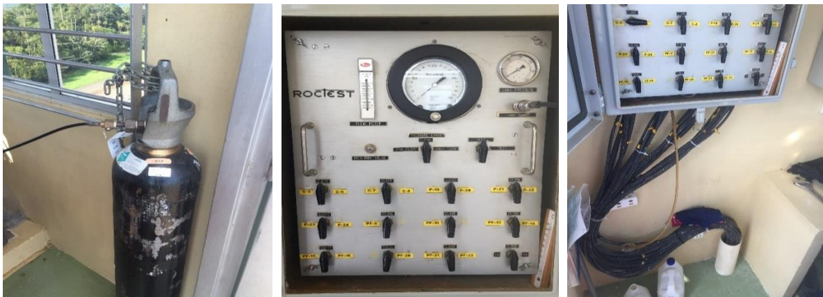
Imagen 8. Consola fija de lectura y cilindro de nitrógeno.
