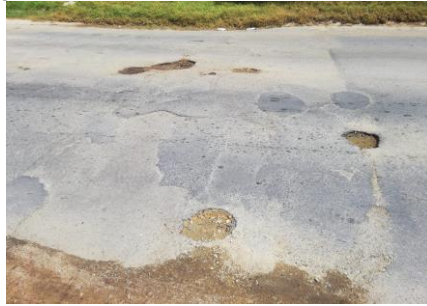
Imagen 3. Estado inicial de la vía Tunja- Chivatá.
