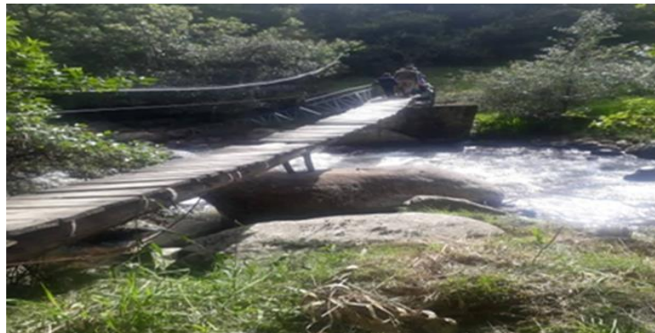
Figura 23. Puente en madera inseguro.
