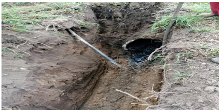
Figura 20. Tramo alcantarillado afectado.
