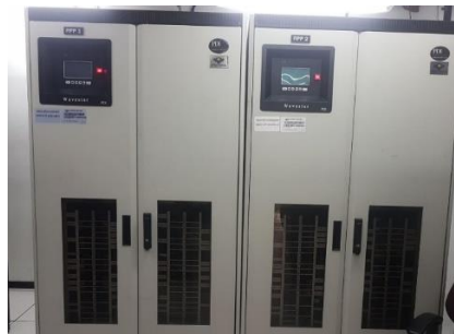
Figura 9. Tablero Principal Eléctrico
