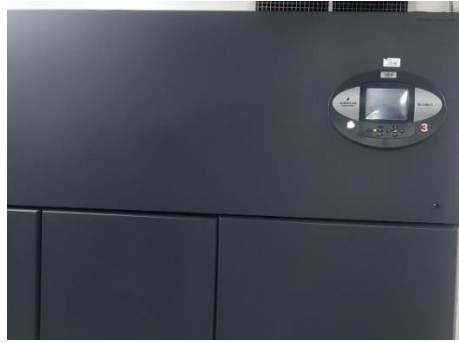
Figura 8. HVAC marca Liebert
