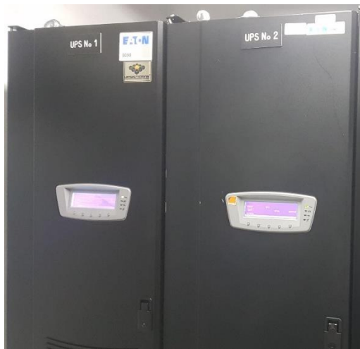
Figura 7. UPS marca Eaton
