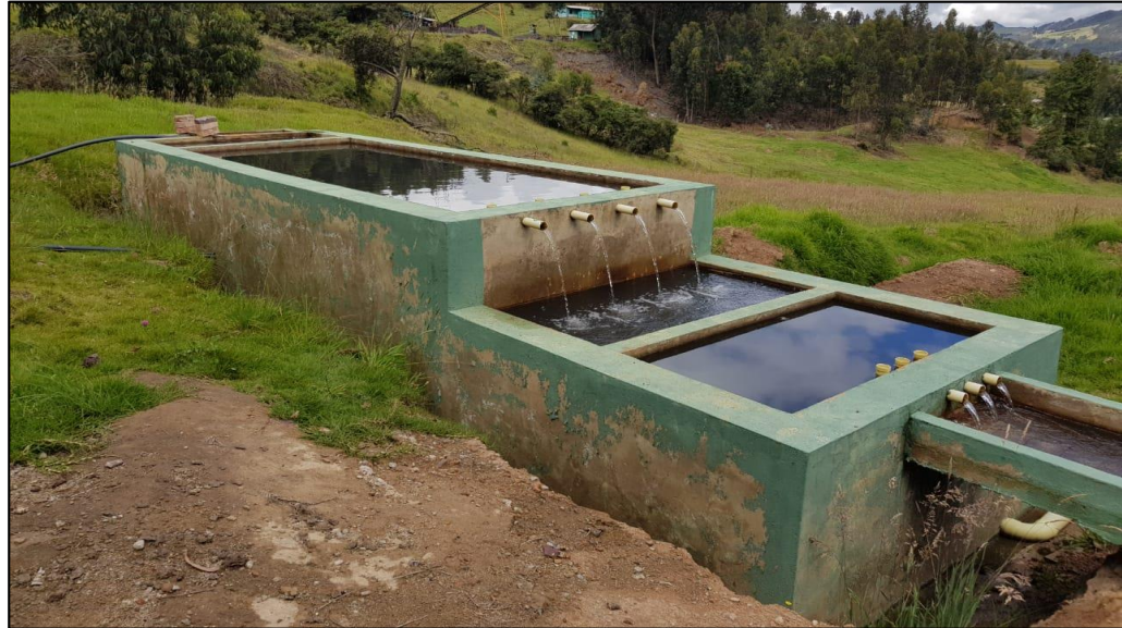
Ilustración 23 Planta de tratamiento mina el Cardon
