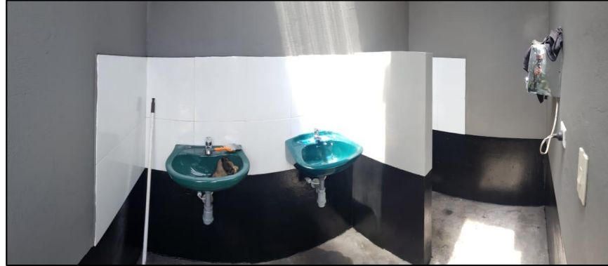
Ilustración 25 Acabados baño bascula
