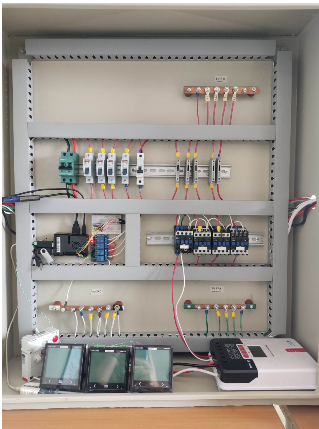
FIGURA 24: Montaje experimental de los circuitos eléctricos de potencia y monitoreo y gestión. Tomado de: Autores.
