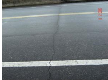
Fig. 1: Daño encontrado en pavimento flexible
