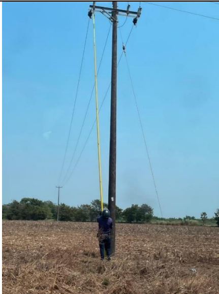
Figura 15. Atención de corte de energía. Fuente: Aliar S.A.
