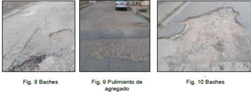
Figura 18. Patologías presentes en la vía de estudio del barrio Jordán. Fuente. Propia
