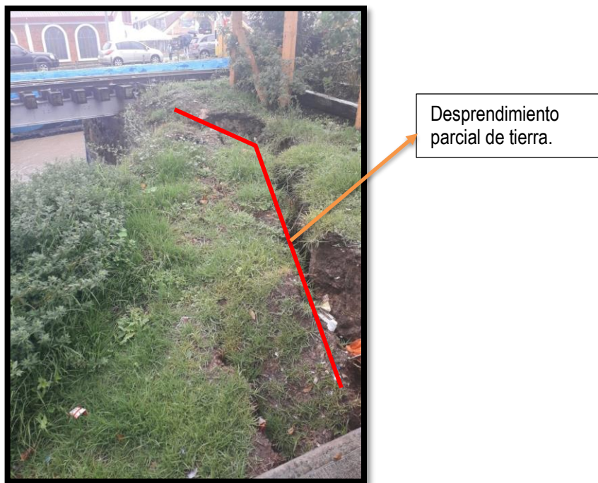
Figura 8. Desprendimiento parcial muro de contención en el sector del Barrio Santa Inés. Fuente. Autor
