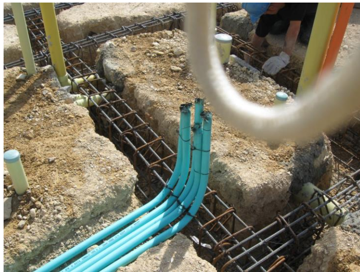
Ilustración 22 Tendido eléctrico (foto de ejemplo)
