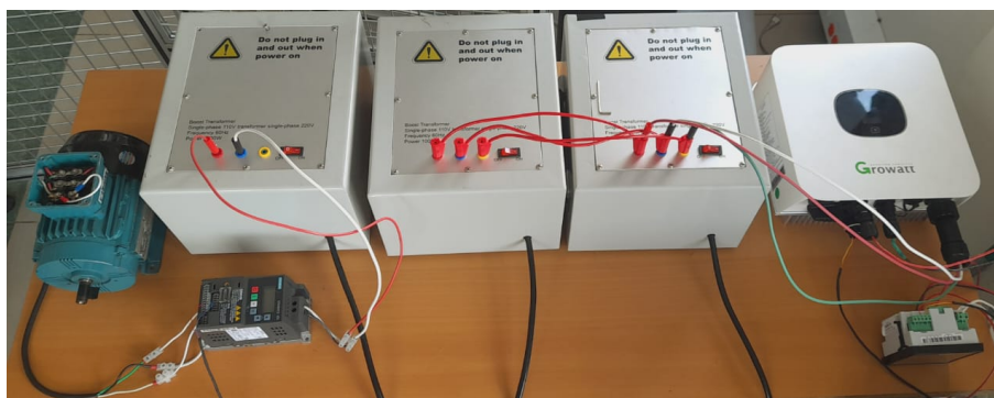
Figura 7.2: Montaje de motor e inversor con transformadores
