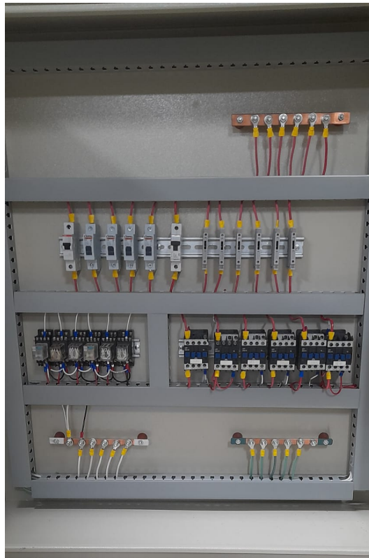
Figura 7.1: Tablero de conexiones principal
