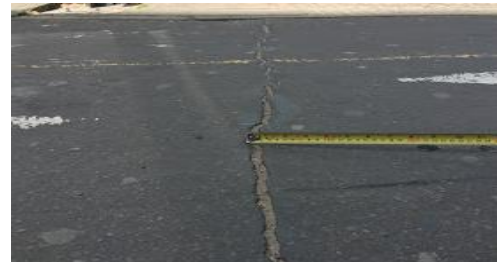
La fisura atraviesa el carril bidireccional
