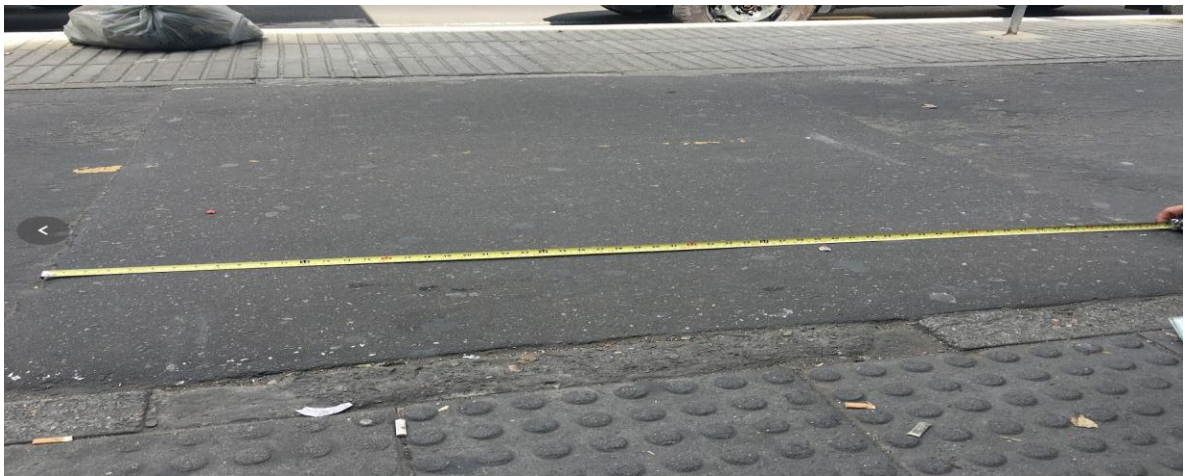
Ilustración 19: Punto crítico tramo 6 tipos de daño parche y fisura de borde con severidad alta.
