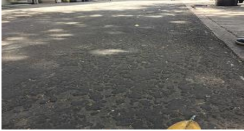
Exudación en gran parte de la carpeta asfáltica del tramo de la carrera 13 entre calles 55 y 56bis.
