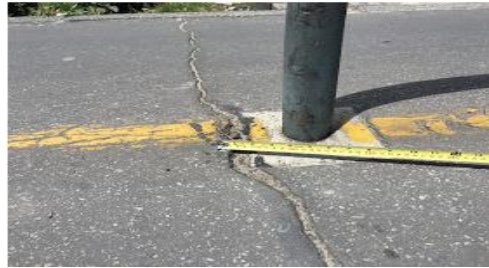
La fisura atraviesa el carril bidireccional
