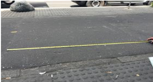
Parche de concreto asfaltico.
