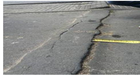
Se presenta levantamiento de la carpeta asfáltica del carril en todo su ancho, a causa de las raíces del árbol cerca al tramo, de igual manera se presentan fisuras y por esta razón el ancho de reparación deberá ser mayor.
