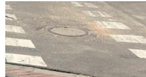
Tapa pozo de aguas sanitarias presenta un hundimiento de 3 cm con respecto a la rasante, esta tapa está ubicada en la intersección de la calle 54 con cra 13 y de igual forma se ubica en centro del ciclocarril.
