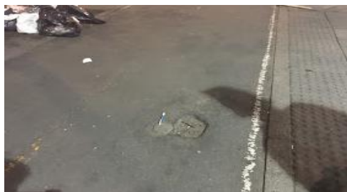
Bache con una profundidad de 1,8 cm con referencia a rasante.
