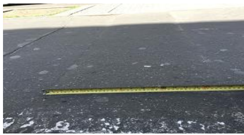
Parche de concreto asfaltico.
