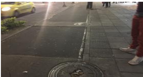
Parches en concreto simple, se evidencia tapas de pozos sobre la Cicloruta de manera parcial.
