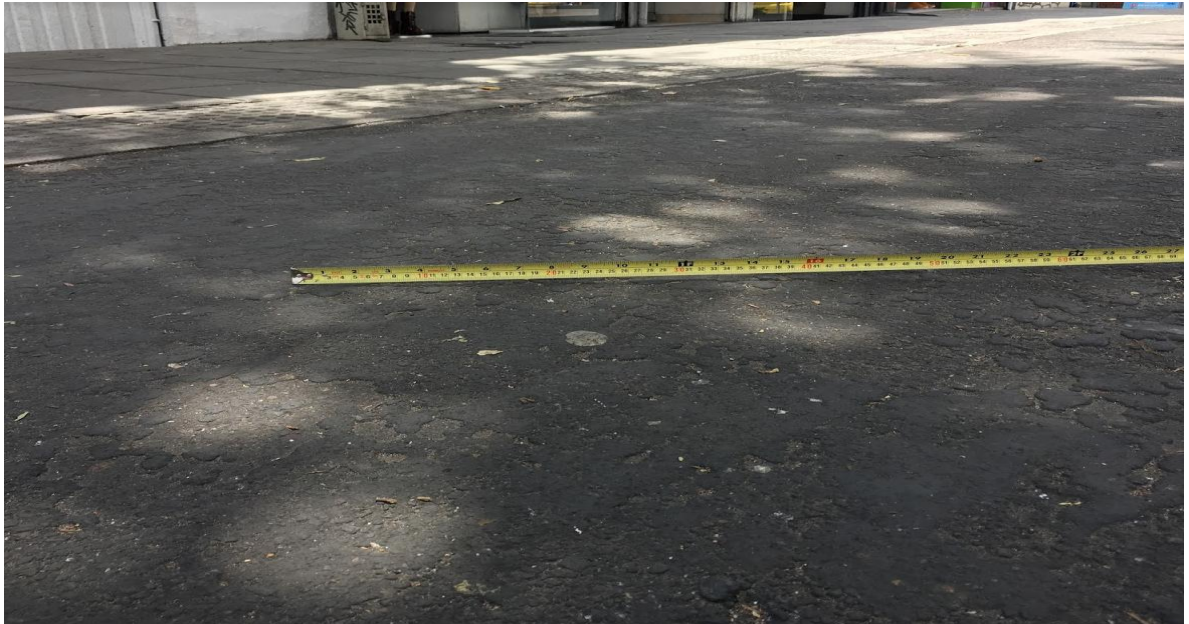
Ilustración 18: Punto crítico tramo 6 daño superficial exudación. Fuente propia.
