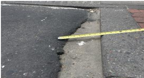
Bache con una profundidad de aproximadamente 2,6 cm, con referencia a la rasante.
