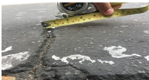
La fisura atraviesa el carril bidireccional.
