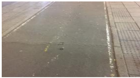
La fisura atraviesa el carril bidireccional.
