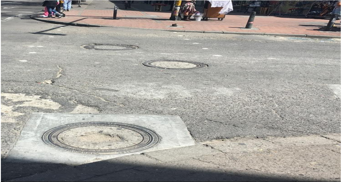
Ilustración 15: Problemática intersección calle 60 con carrera 13. Fuente propia.
