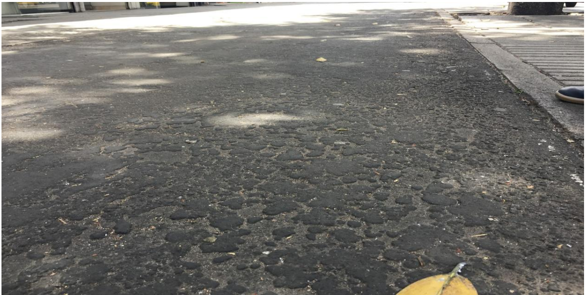
Ilustración 17: Punto crítico tramo 6 daño superficial pérdida de agregado. Fuente propia.
