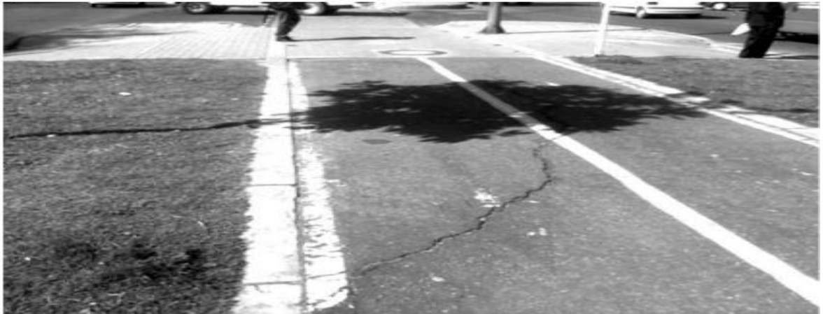
Ilustración 6: Fisura en diagonal causada por expansión de subrasante. MARTINEZ, Gilberto, FUENTES, Luis y TORREGROZA, Lina. Revisión del sistema de gestión de pavimentos de la red Ciclorutas de Bogotá En : revista Ingeniería de construcción [en línea]. Vol.26 N° 2, (2011). P. 62.
