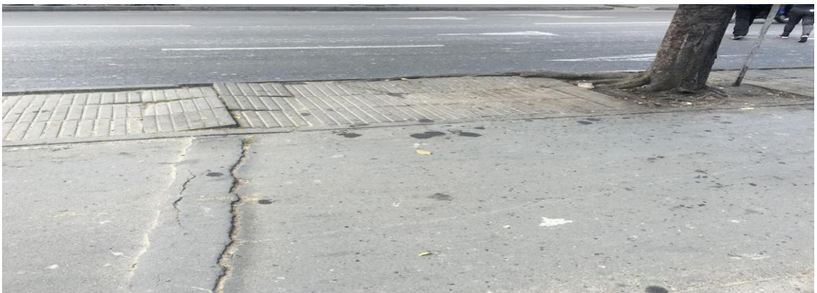
Ilustración 11: punto crítico tramo 2, fisura transversal con severidad alta. Fuente propia.
