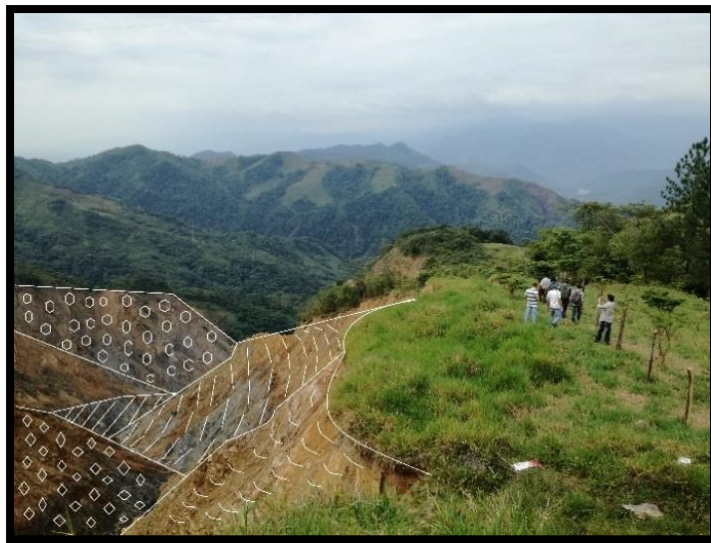
Figura 4- 1 Deslizamientos en el área de estudio
