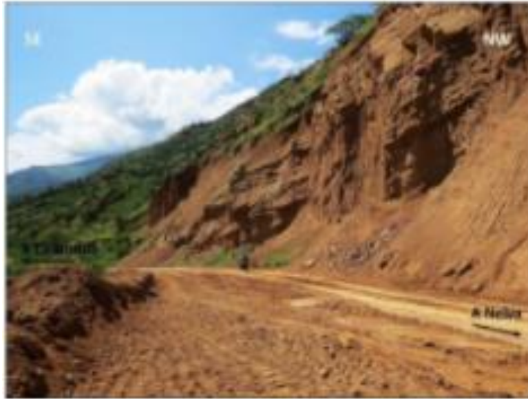
Figura 15 Vereda Boca de la Zanja Caída de Rocas fuertes Fuente: [24]
