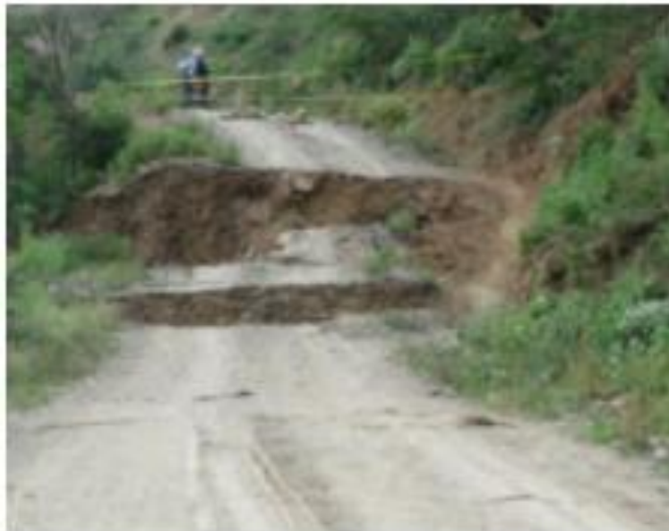
Figura 16 Ruptura en terraplén vereda Ariari Fuente: [24]
