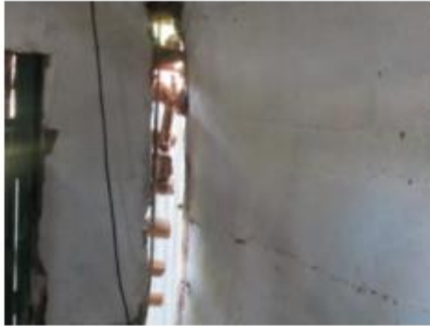
Figura 13 Separación de muros de bahareque Fuente: [24]
