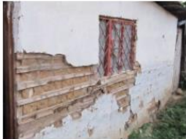
Figura 14 Perdida de recubrimiento en ventana y muro Fuente: [24]
