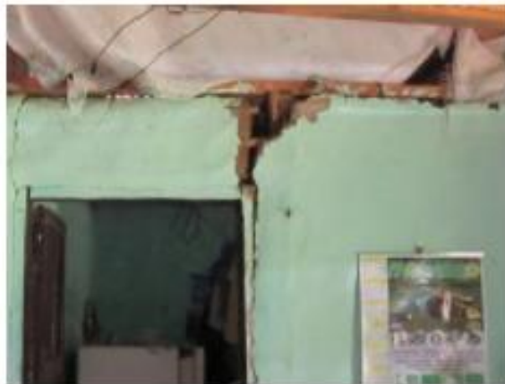
Figura 12 Caída parcial de revestimiento en vivienda de bahareque Fuente: [24]
