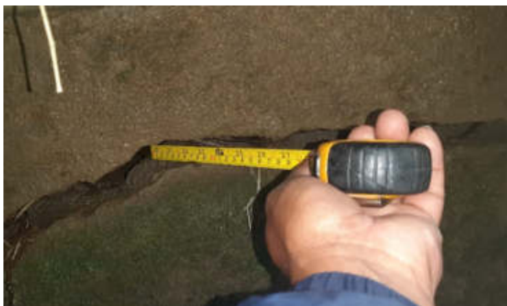
Figura 10. Grietas en estribo costado norte.
