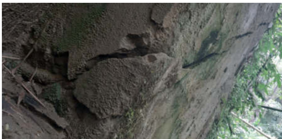
Figura 14. desprendimiento de piezas de concreto.
