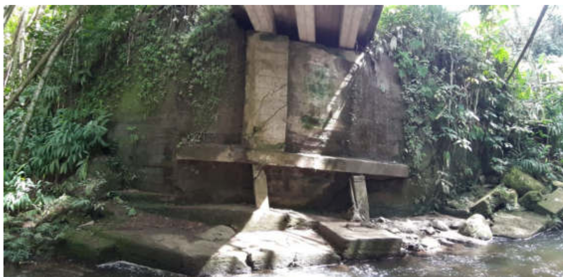
Figura 9. Grietas en estribo costado norte.
