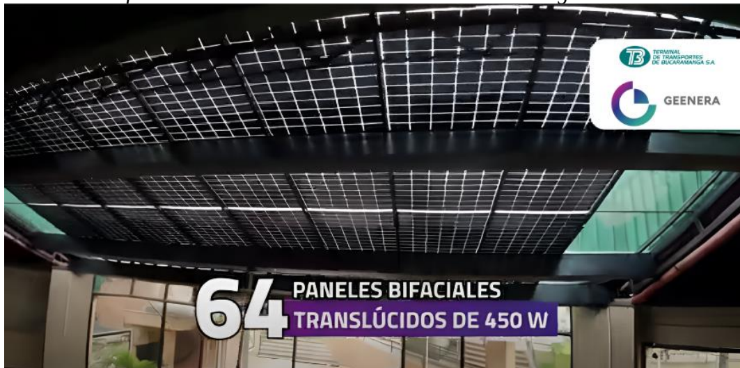
Figura 5. Paneles bifaciales instalados en el terminal de Bucaramanga.
