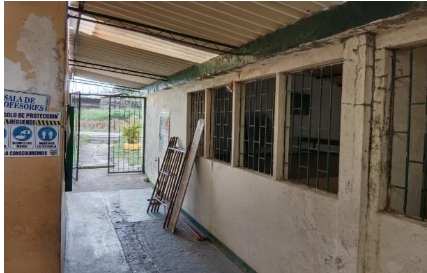
Figura 8. Salones en mal estado sede Anexa
