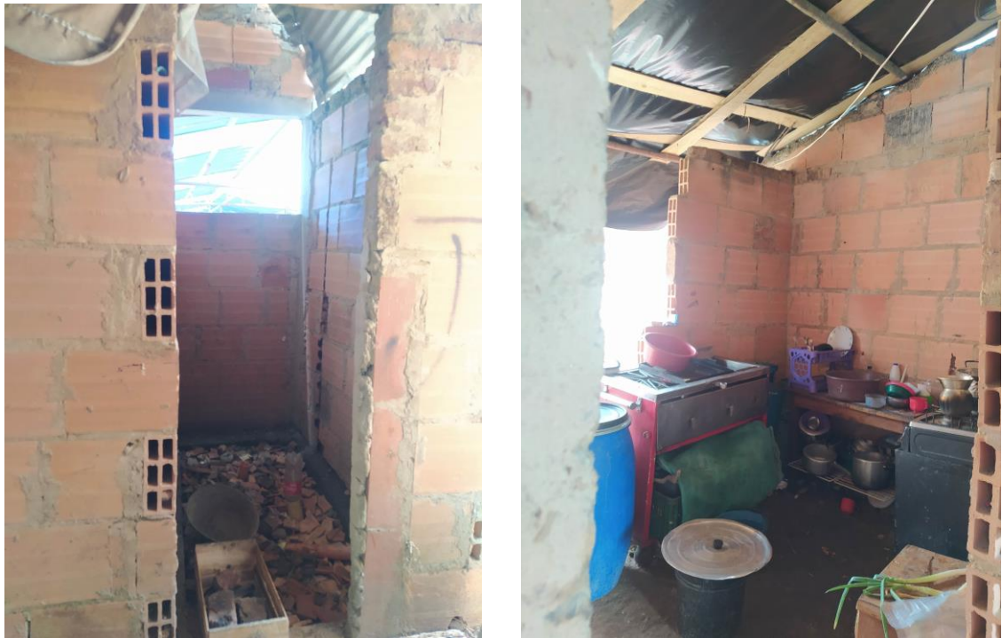
Figura 17. Estado cocina y baño.
