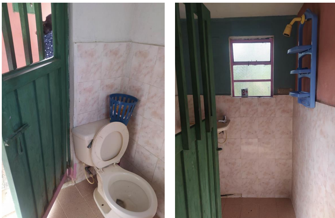
Figura 11. Estado del baño.
