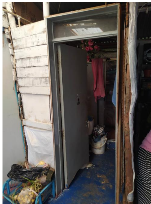
Figura 8. Estado del baño.
