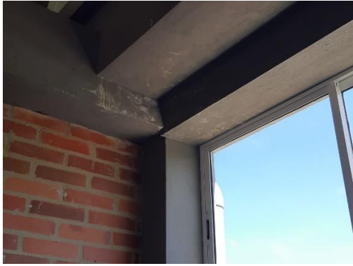
Fotografía 1: vista de deterioro de pintura en parte superior
