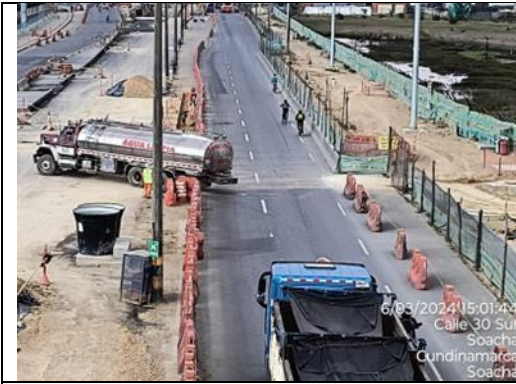
Imagen 56: Registro fotográfico arrastre de material granular sobre la vía, sentido Girardot – Bogotá.
