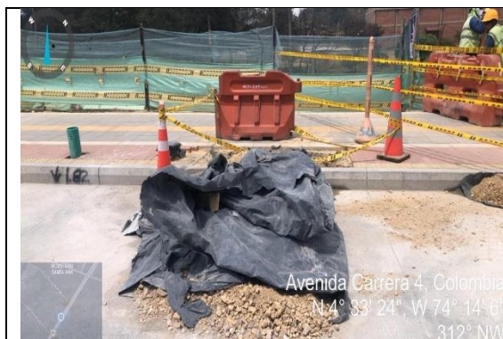
Imagen 7. Acopio de material sin las adecuaciones establecidas en el PMA.
