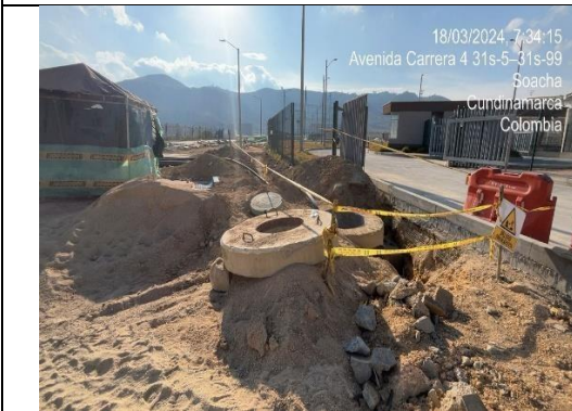
Imagen 60: Registro fotográfico acopio de material sin las adecuaciones establecidas en el PMA V7.
