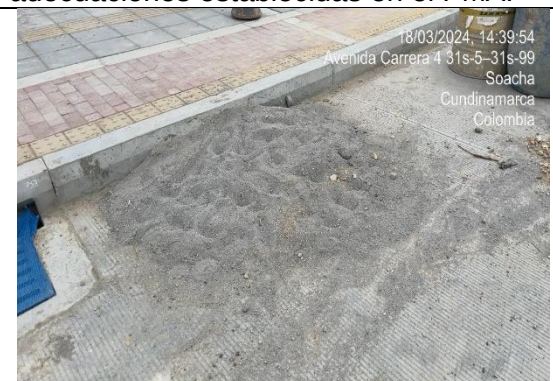
Imagen 11 Acopio de material sin las adecuaciones establecidas en el PMA.
