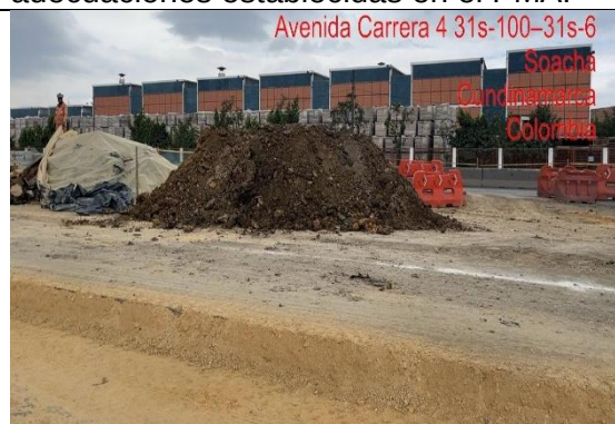
Imagen 9 Acopio de material sin las adecuaciones establecidas en el PMA.
