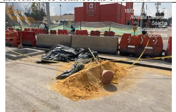
Imagen 12 Acopio de material sin las adecuaciones establecidas en el PMA.
