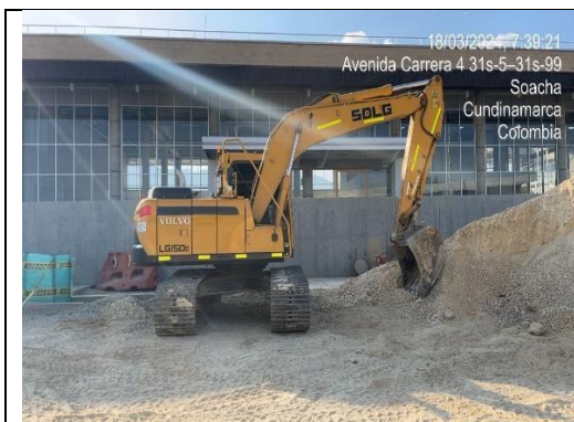
Imagen 62: Registro fotográfico parqueo de maquinaria fuera de zona autorizada y sin los lineamientos del PMA.
