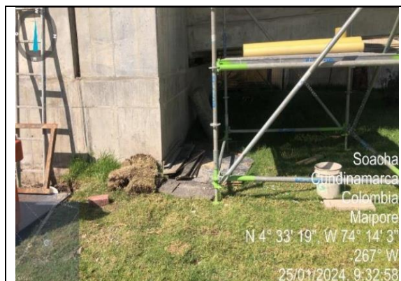
Imagen 24. Afectación a zona de empradizado, acopio de materiales e instalación de estructura.
