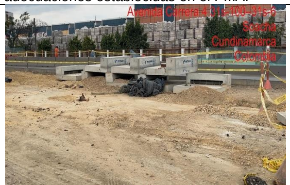
Imagen 10 Acopio de material sin las adecuaciones establecidas en el PMA.
