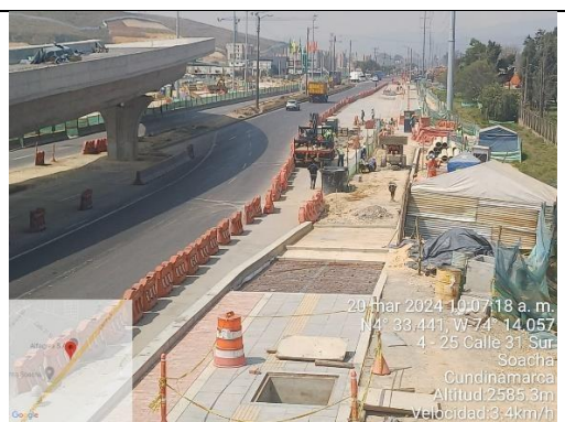
Imagen 65: Registro fotográfico sendero peatonal obstruido por maquinaria.
