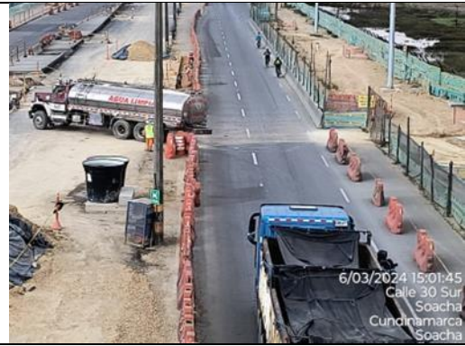
Imagen 57: Registro fotográfico arrastre de material granular sobre la vía, sentido Girardot – Bogotá.
