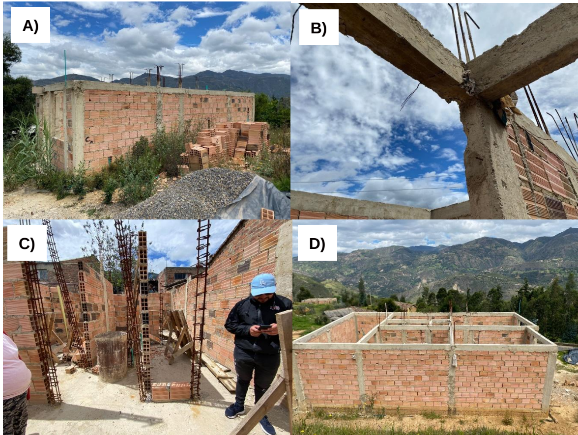
Figura 18. Estado actual viviendas de interés social en Tasco, Boyacá.
