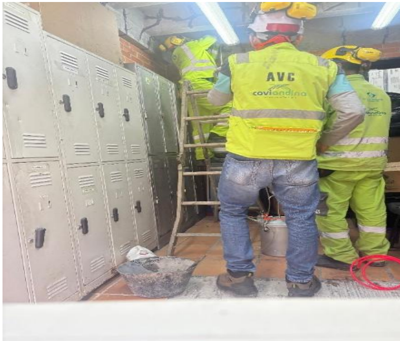
Figura 19 Sello de Fisuras Naranjal.
