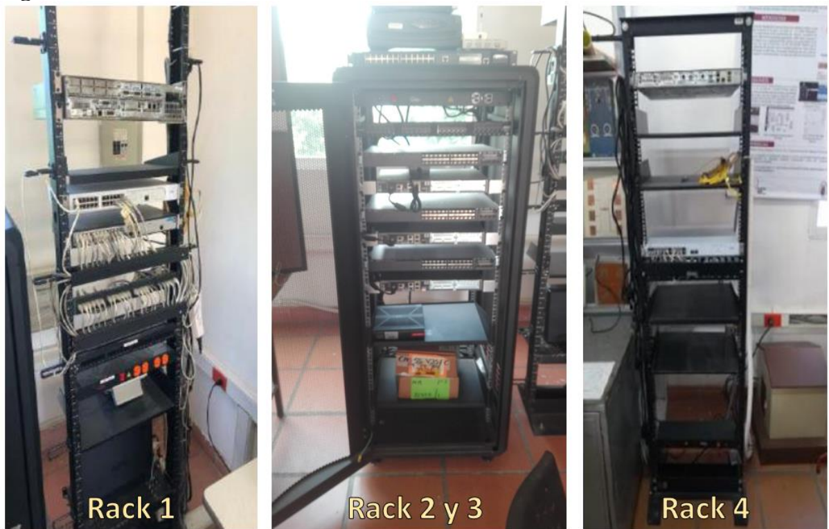
Figura 13. Detalle de los racks de comunicaciones
