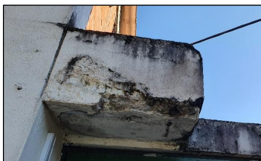
Figura 12. Evidencia de erosión de elemento en concreto.
