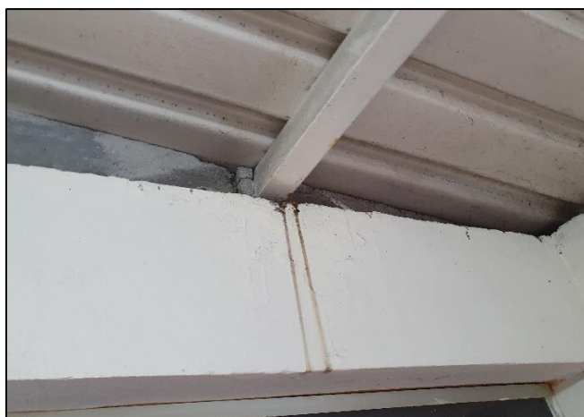
Figura 11. Evidencia de humedad por filtración.
