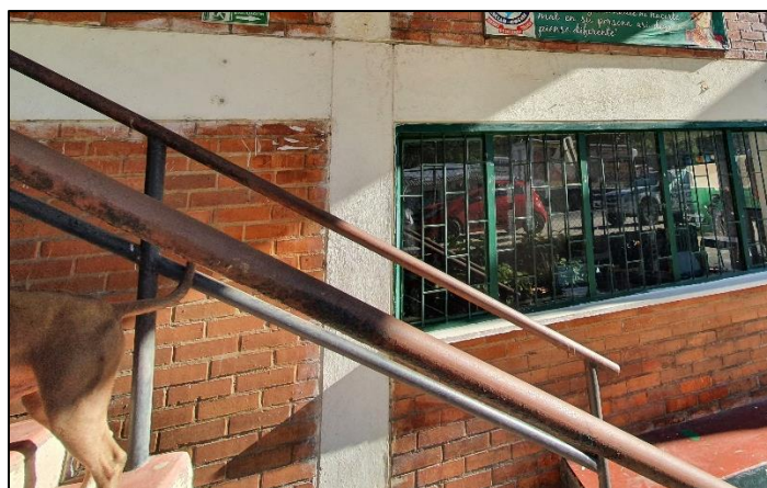
Figura 10. Evidencia de oxidación en barandas de escaleras
