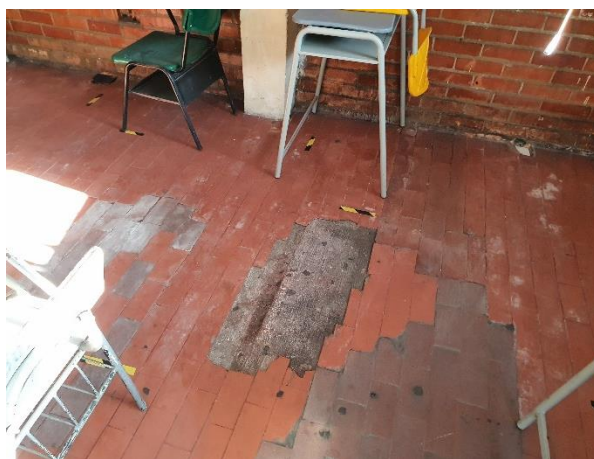
Figura 13. Desprendimiento de enchape.
