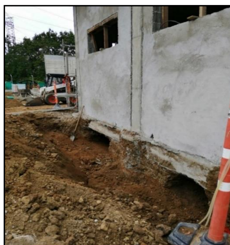
Figura 52. Afectaciones a suelo de cimentación por excavaciones durante el proceso constructivo
