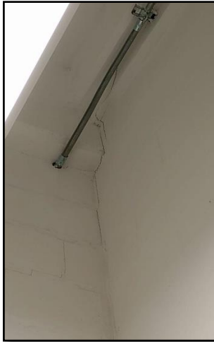
Figura 65. Fisuras en muros de mampostería
