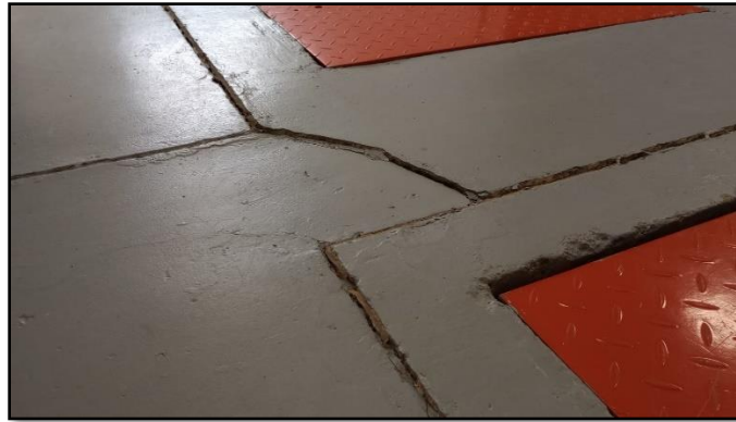
Figura 49. Fisura en losa de contrapiso
