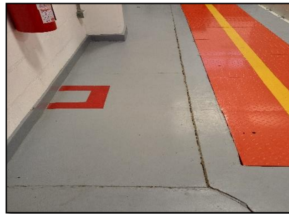
Figura 57. Fisuras en dilataciones de losa de contrapiso
