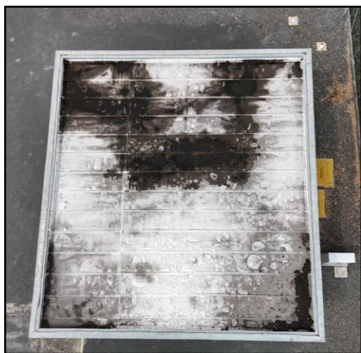
Figura 72. Humedad en cubierta
