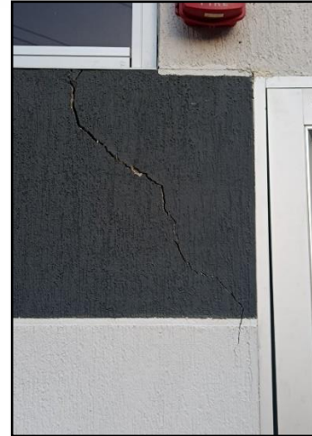
Figura 67. Fisuras en muros de mampostería
