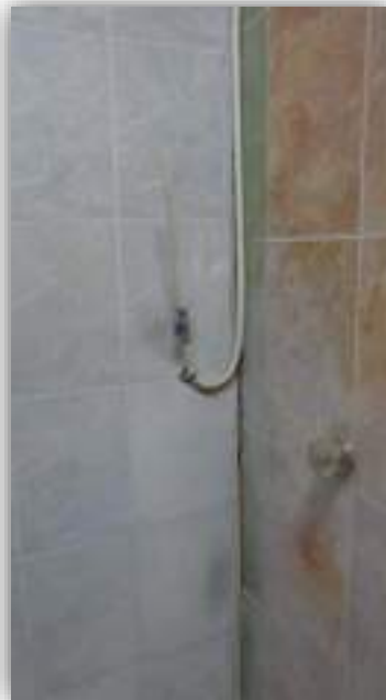
Figura 37. Dilataciones en Muros de Baño.
