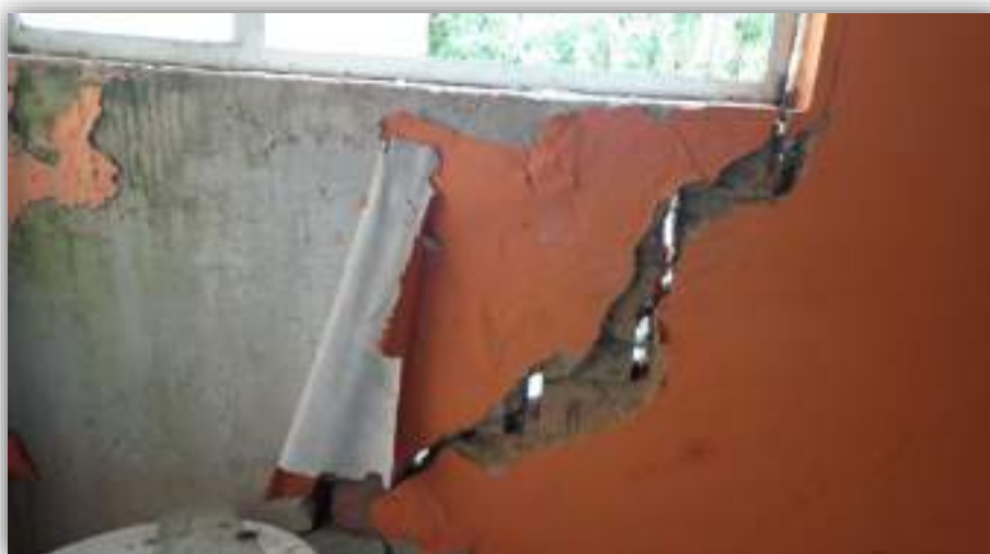
Figura 39. Fisuras Muros Externos.
