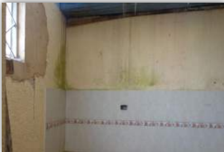
Figura 34. Daños por Humedad en Muros Cocina.
