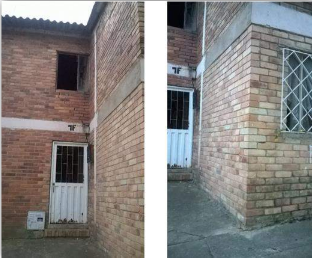
Figura 3. Daños En Fachada.
