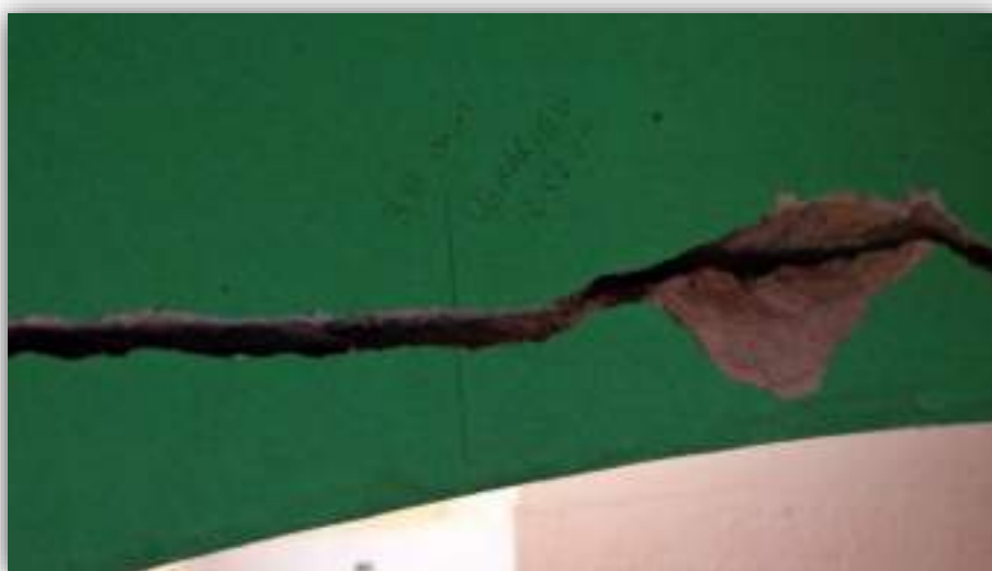
Figura 41. Seguimiento Fisuras Muro Interno Arco Sala.
