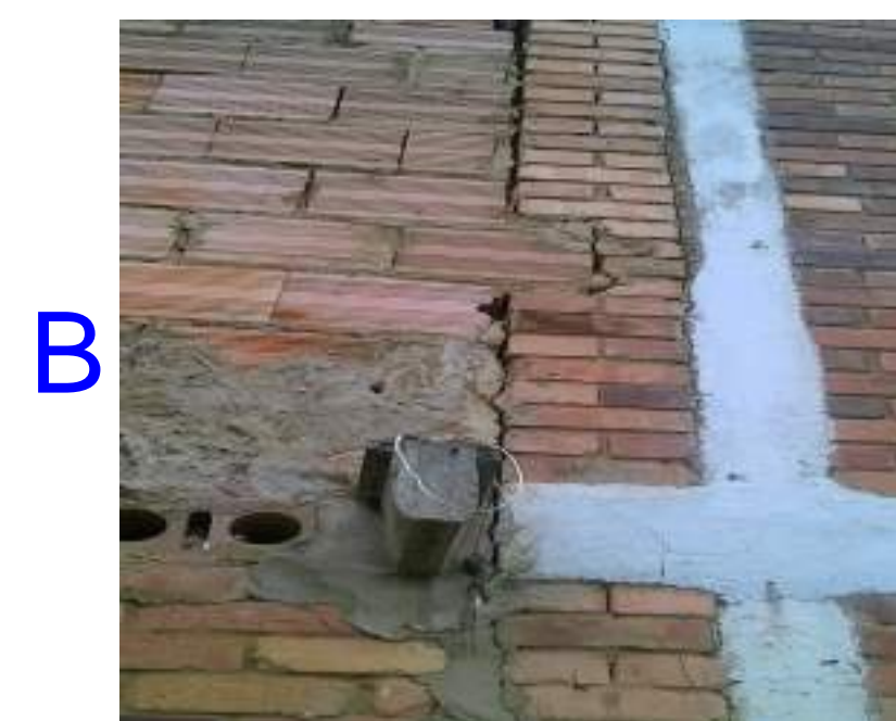
GRIETAS- CAMBIOS DE MATERIALES DESPRENDIMIENTO .
