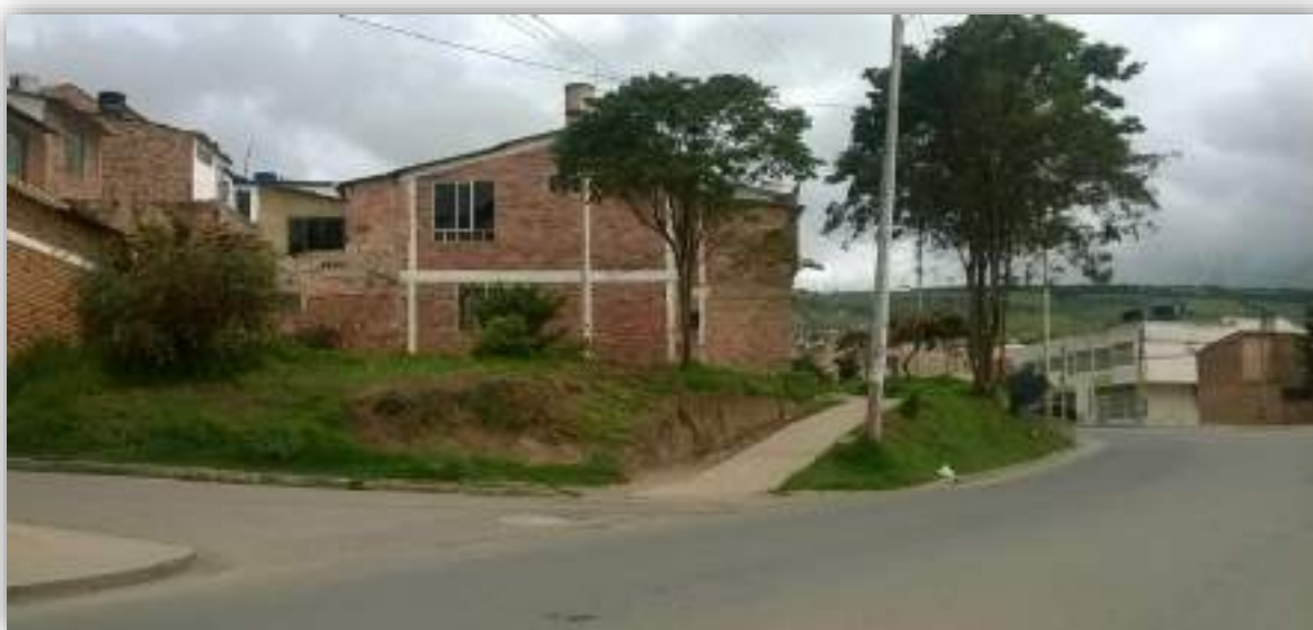
Figura 17. Estado Talud adyacente.
