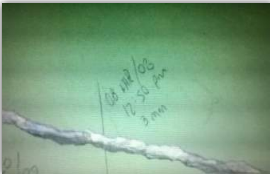
Figura 40. Seguimiento Fisuras Muros Internos.
