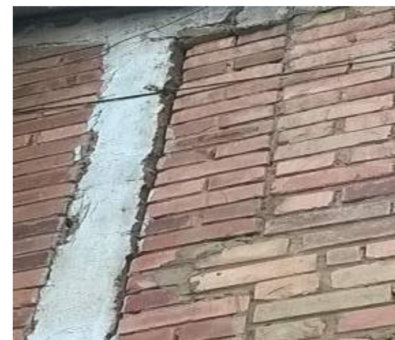
FISURA EN ELEMENTO ESTRUCTURAL Y UNION DE MATERIALES
