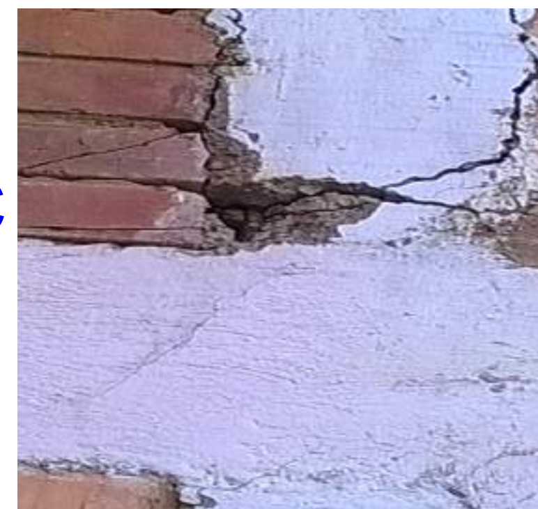
FISURA EN ELEMENTO ESTRUCTURAL
