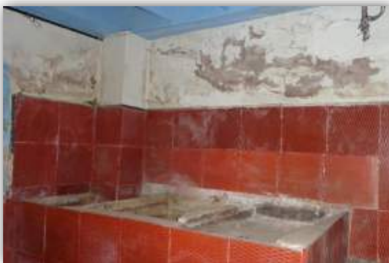
Figura 35. Daños por Humedad en Muros Patio de Ropas.
