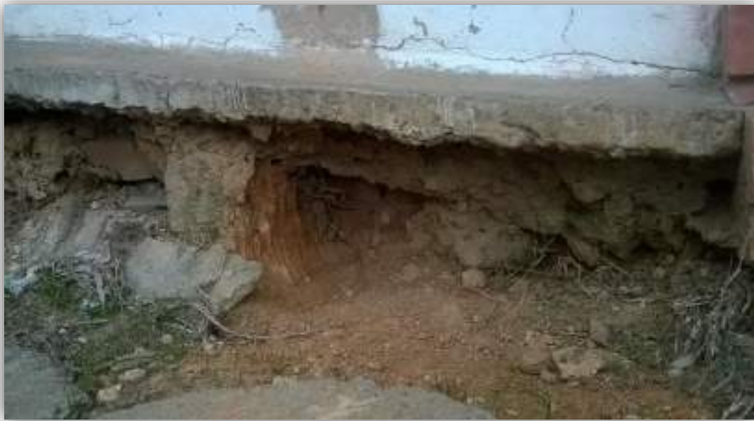
Figura 19. Estado Erosión en Suelo de Cimentación.
