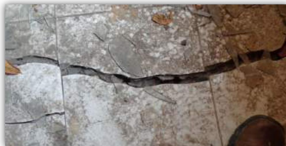
Figura 44. Daños en Pisos Segundo Nivel.
