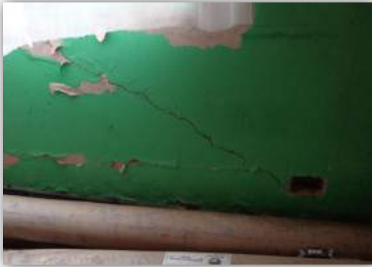
Figura 36. Fisuras en Muro de Fachada Lateral.
