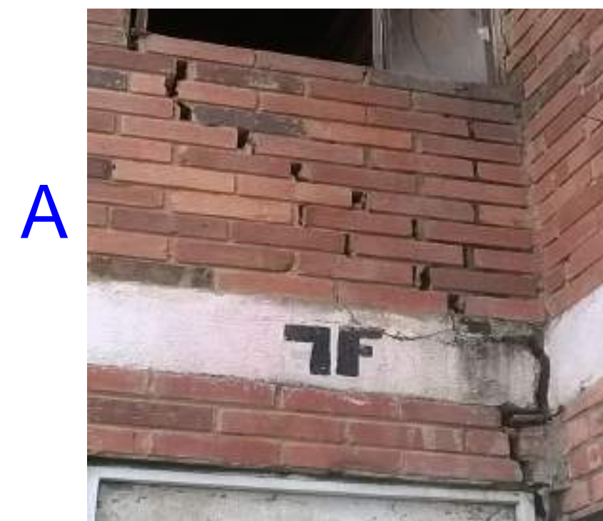
GRIETAS BAJO VENTANA- EN ELEMENTO ESTRUCTURAL
