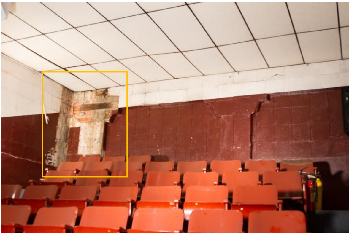
Figura 118 Grietas presentes en palco
