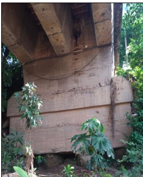
Figura 8 Descripción: viga central vista general - Ubicación: Pilar margen derecha Fuente: elaborado por el autor
