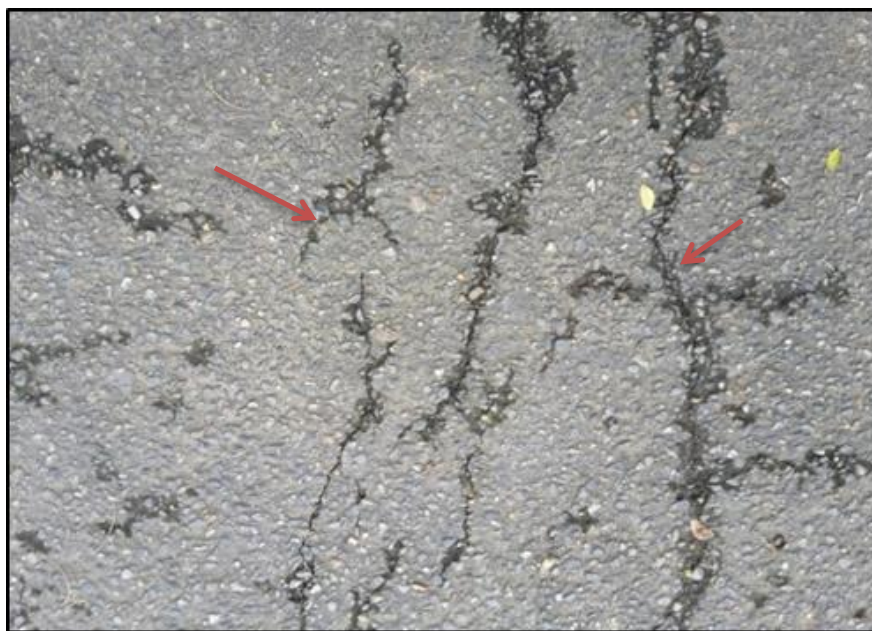
Figura 12 Descripción: Fisuramiento en la superficie del pavimento flexible. - Ubicación: Pavimento flexible Fuente: elaborado por el autor
