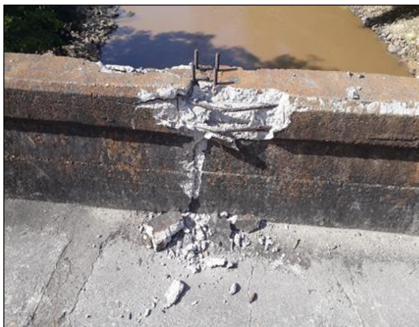
Figura 10 Descripción: Pérdida de material, exposición del refuerzo. - Ubicación: Baranda costado sur. Fuente: elaborado por el autor.
