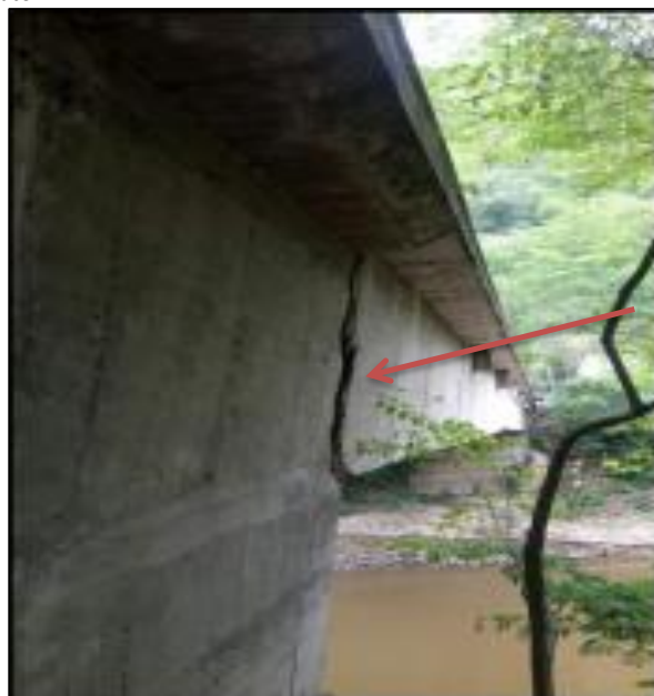
Figura 4 Fractura en una de las dovelas del puente Fuente: elaborado por el autor
