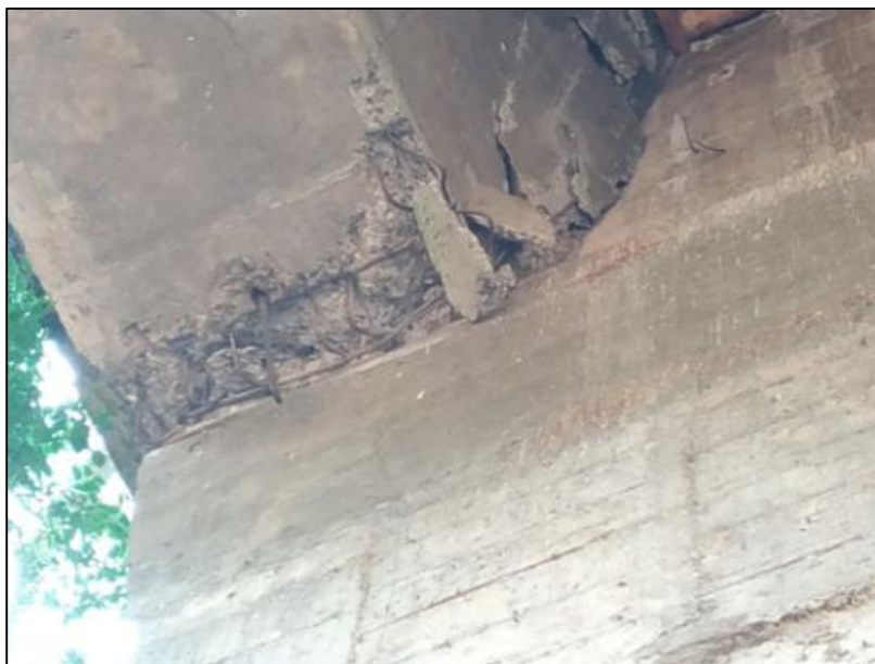
Figura 9 Descripción: Pérdida de material y exposición del refuerzo. - Ubicación: Dovela parte inferior Fuente: elaborado por el autor.
