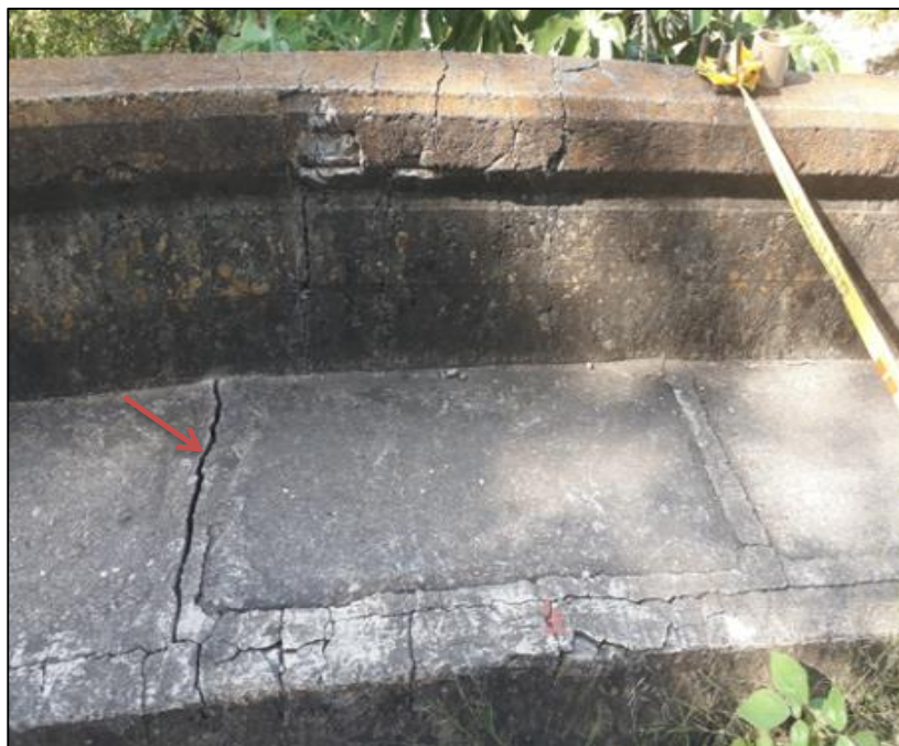
Figura 11 Descripción: Fisuramiento transversal. - Ubicación: Andén Fuente: elaborado por el autor.
