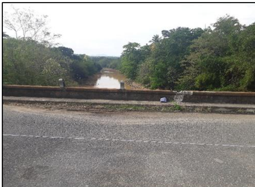
Figura 13 Descripción: Hundimiento. - Ubicación: Pavimento flexible Fuente: elaborado por el autor
