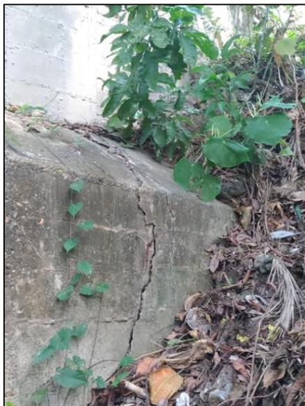
Figura 7 Descripción fisuramiento viga central detalle Fuente: elaborado por el autor
