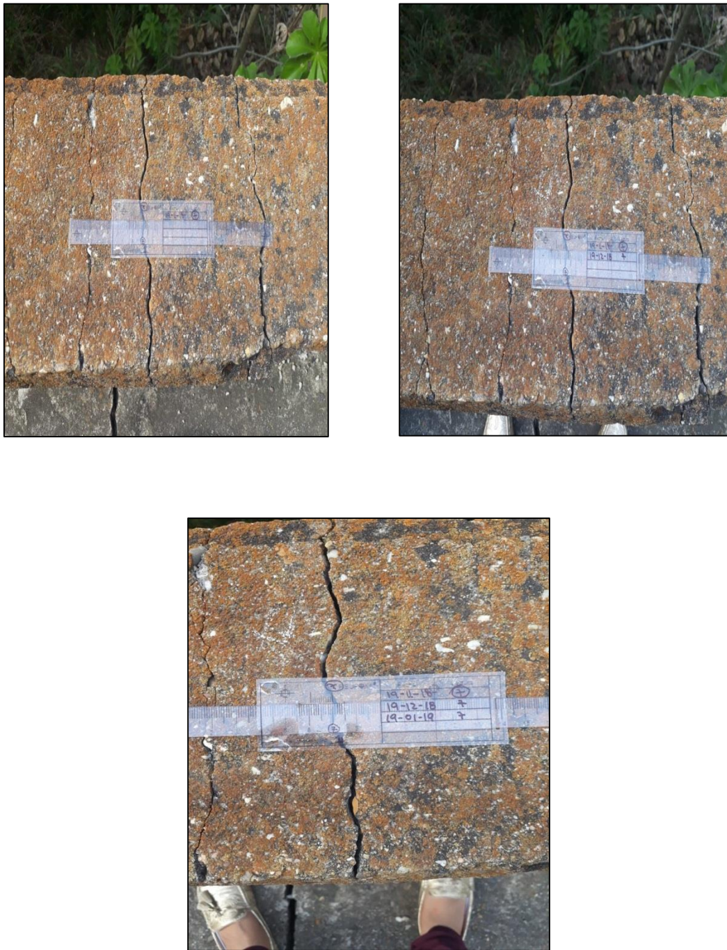
Figura 14 Fisurómetro colocado en el puente con la medida de la separación tomada en diferentes fechas. Fuente: elaborado por el autor
