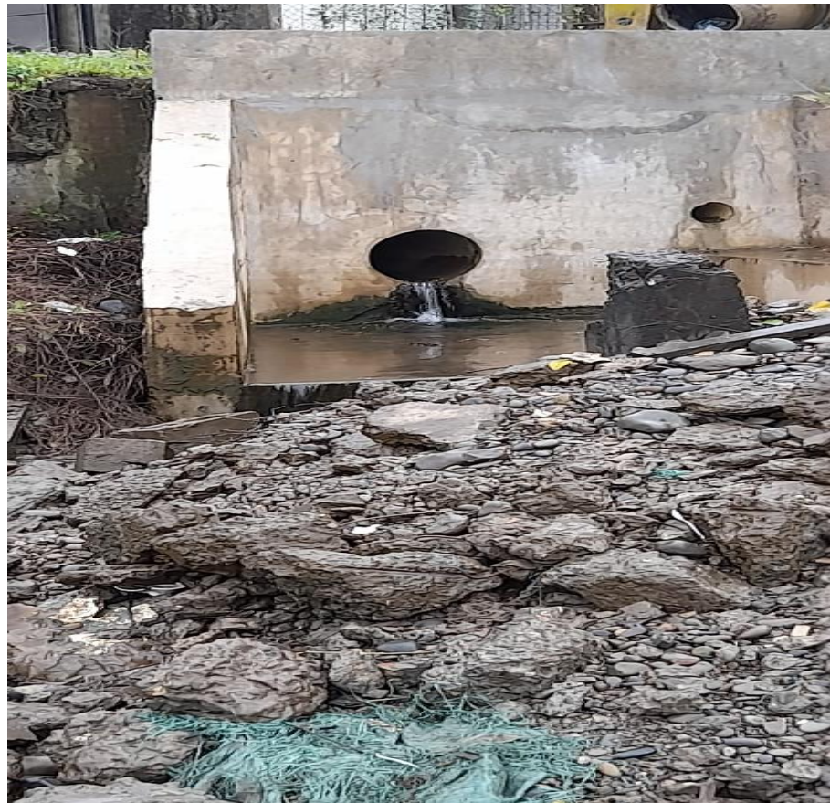
Ilustración 6: Vertimiento de aguas servidas al estero San Antonio, bahía de Buenaventura: Fuente: el autor.
