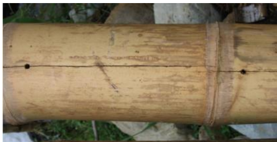
Ilustración 10 Agrietamiento de Elementos de Guadua
