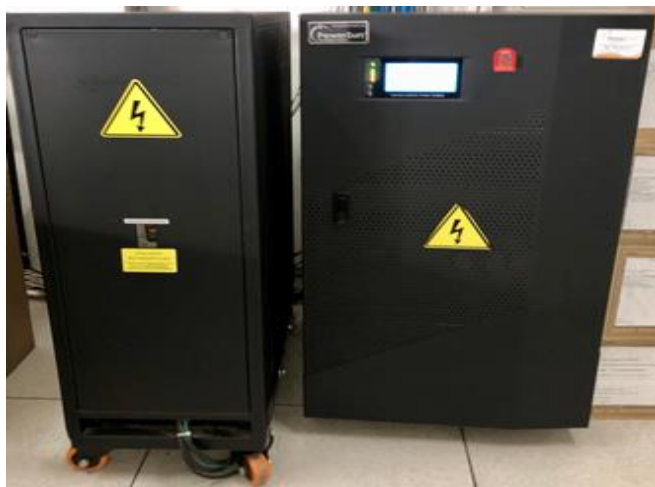
Figura 8. UPS, fuente: propia.
