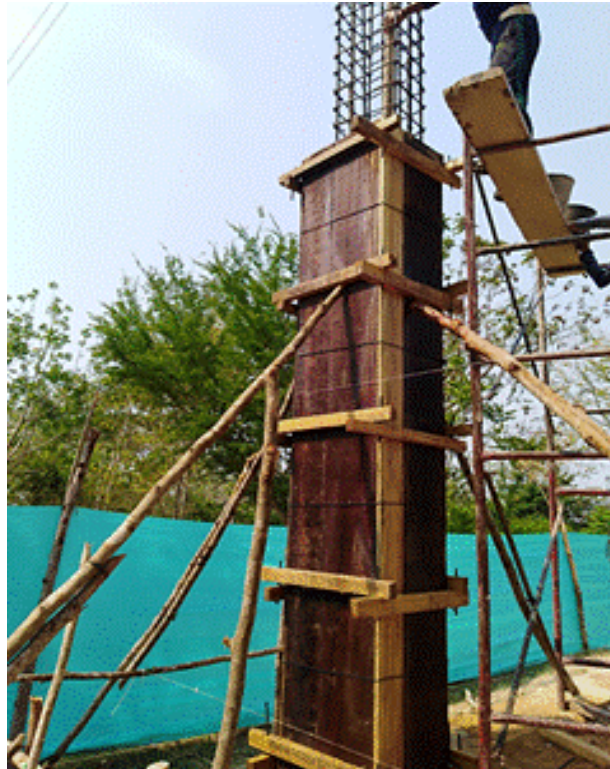
Figura 17. Actividad de formateado en madera de columnas de estructura de cubierta de la cancha
