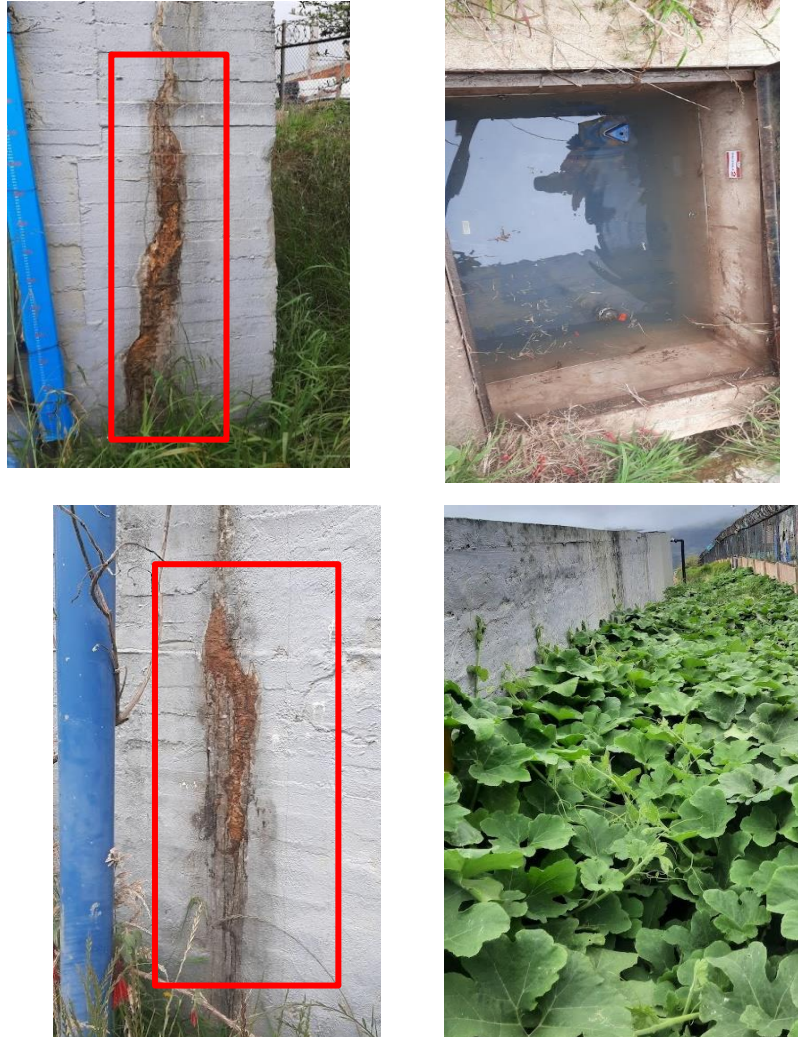
Figura 6. Visita tanque Colinas.
