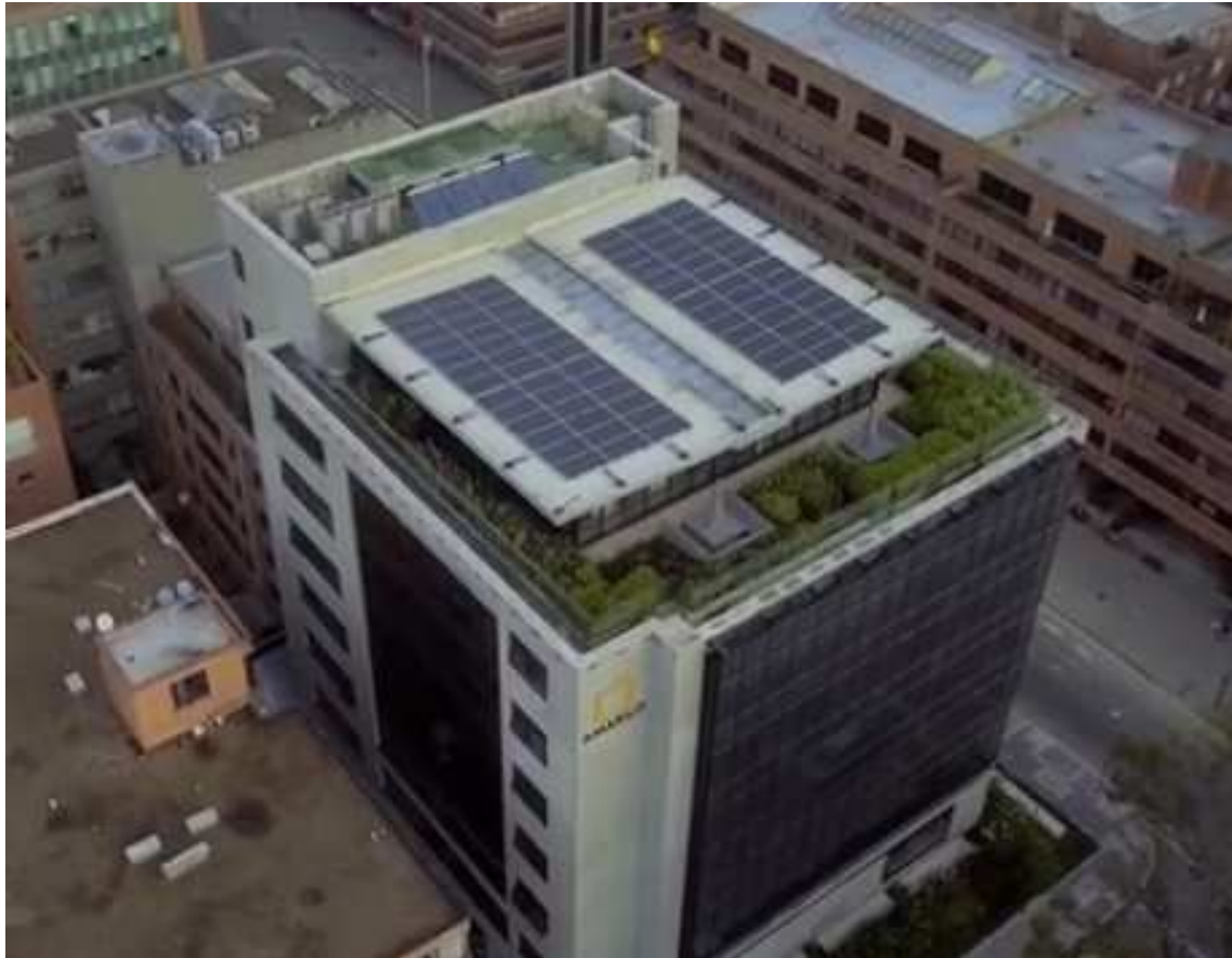
Figura 20. Paneles de energía solar cubierta Edificio Corporativo Amarilo
