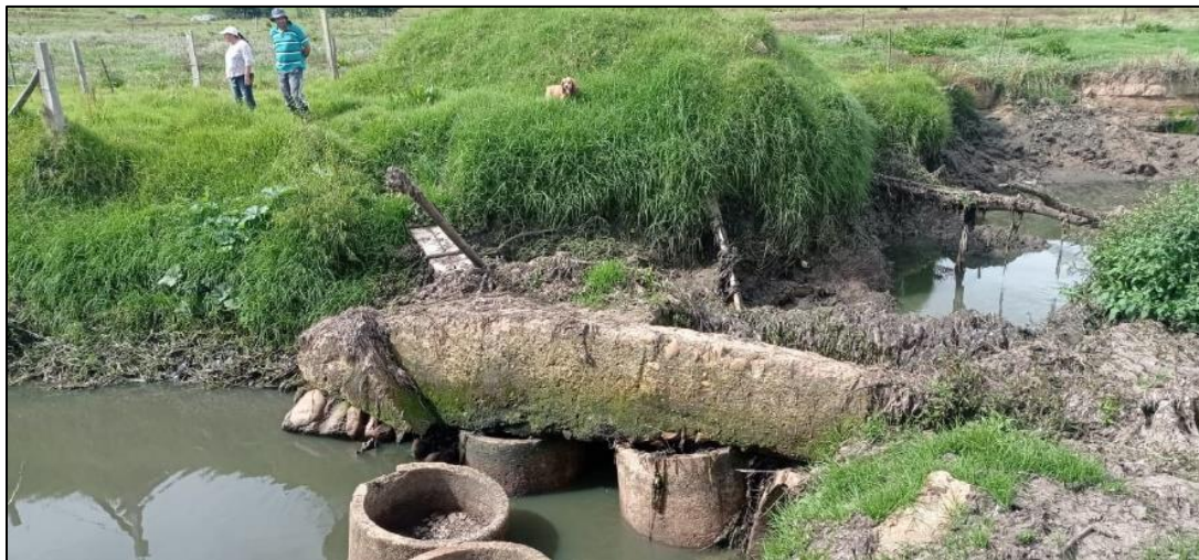
Imagen 6 Desplazamiento de tubería
