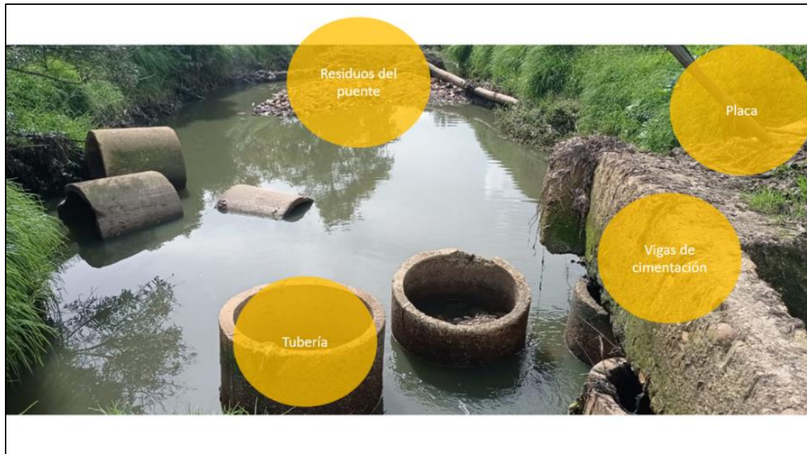
Imagen 3 Colapso de puente
