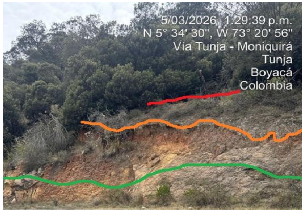
Figura 8 Partes del movimiento del Talud
