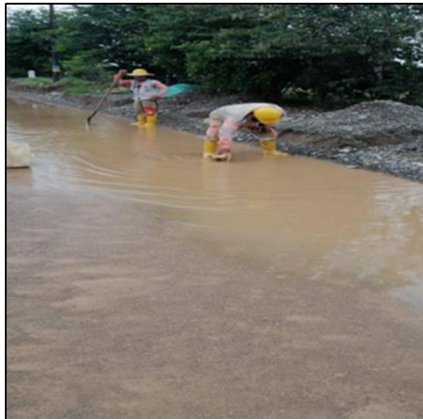
Figura 19. Inundación y desprendimiento de material de la unidad 3. Fuente: (Corredor Fabian, 2022).
